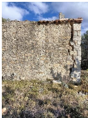
Figura 41. Grietas en fachada Oeste de la Ermita de Santa Bárbara, 2024. Elaboración propia.
