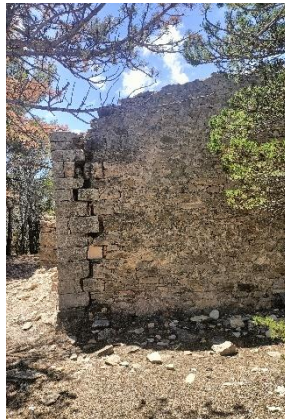
Figura 40. Grietas en fachada norte de la Ermita de Santa Bárbara, 2024. Elaboración propia.
