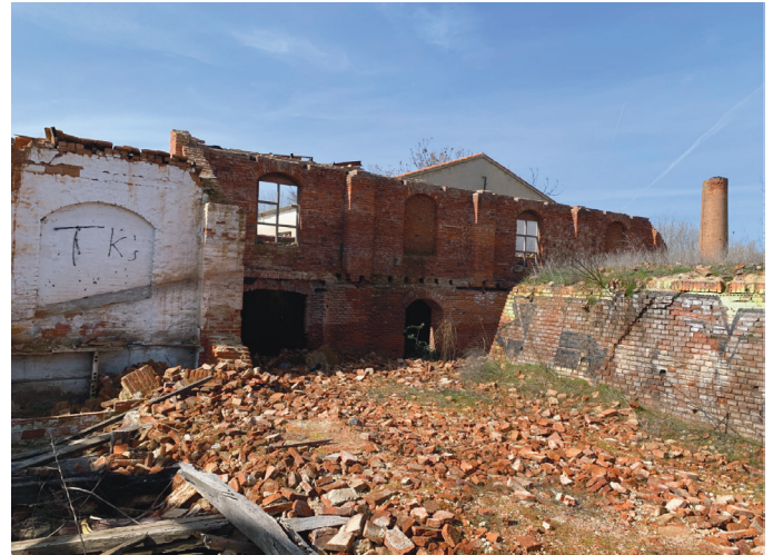
fig.9. Fábrica derrumbada de ladrillos San Antonio. El Perdigón, Zamora. 2022.
