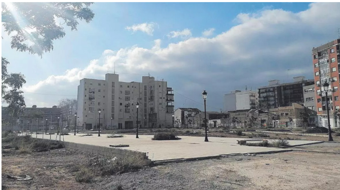
Ilustración 23: Obras de urbanización paralizadas en la actuación del Cuartel de Ingenieros: Fuente: Levante EMV, 2024
