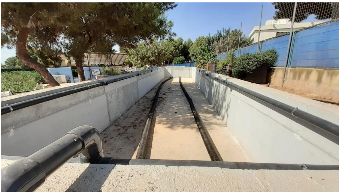
Figura 27. Tuberías de entrada (superficie) y tuberías de descarga (fondo) del humedal.
