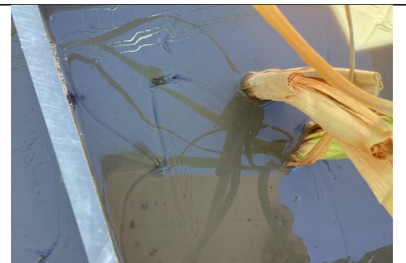
Día 35: Paso de lodo a través de las grietas en H-2.
