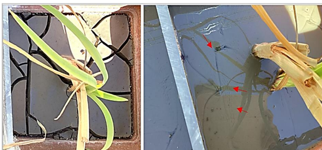
Figura 23. Paso del lodo a través de las grietas en el lecho del H-2.
