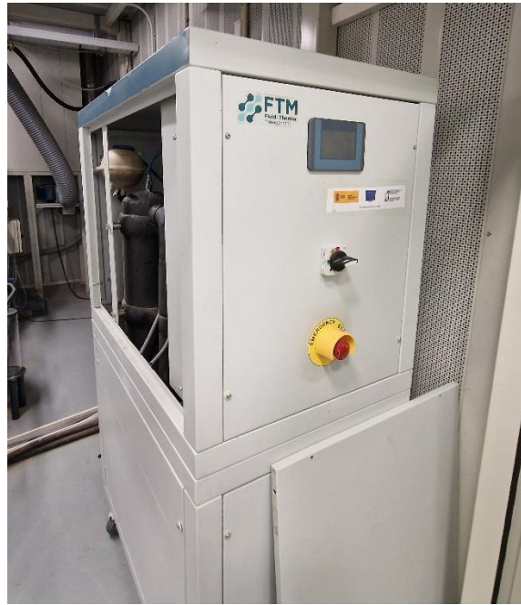
Figura 4.16. Dispositivo Fluid & Thermal management
