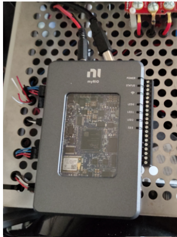
Figura 38: MyRIO montado con sus respectivos cables
