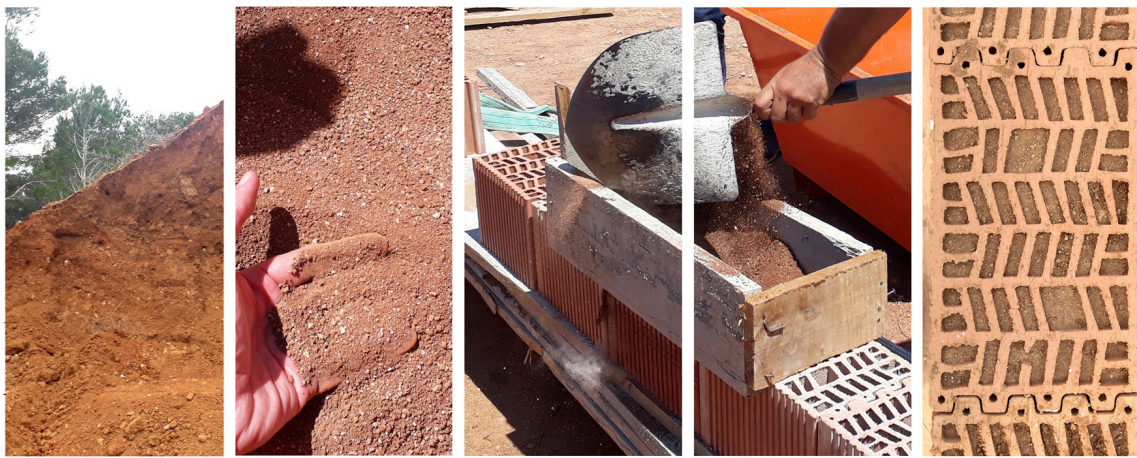
Ilustración 62_Excavación – acopio de tierras – filtración a tierra fina – relleno de muros de termoarcilla. 24 VPP en Ibiza. Fuente: 08014 Arquitectura
