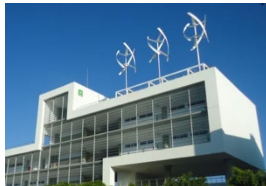
Figura 21. Generadores mini eólicos. Fuente: ecotechgeccai
