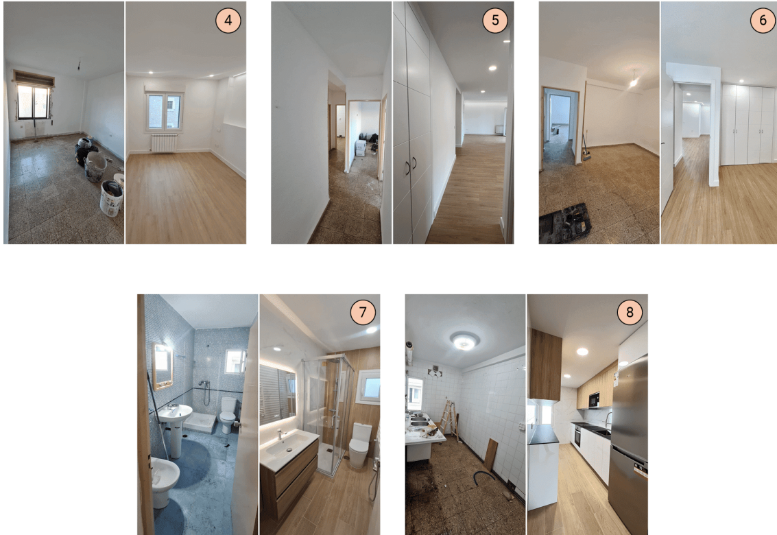
Figura 54: Plano estado inicial de la vivienda existente con imágenes de antes y después de la reforma.
