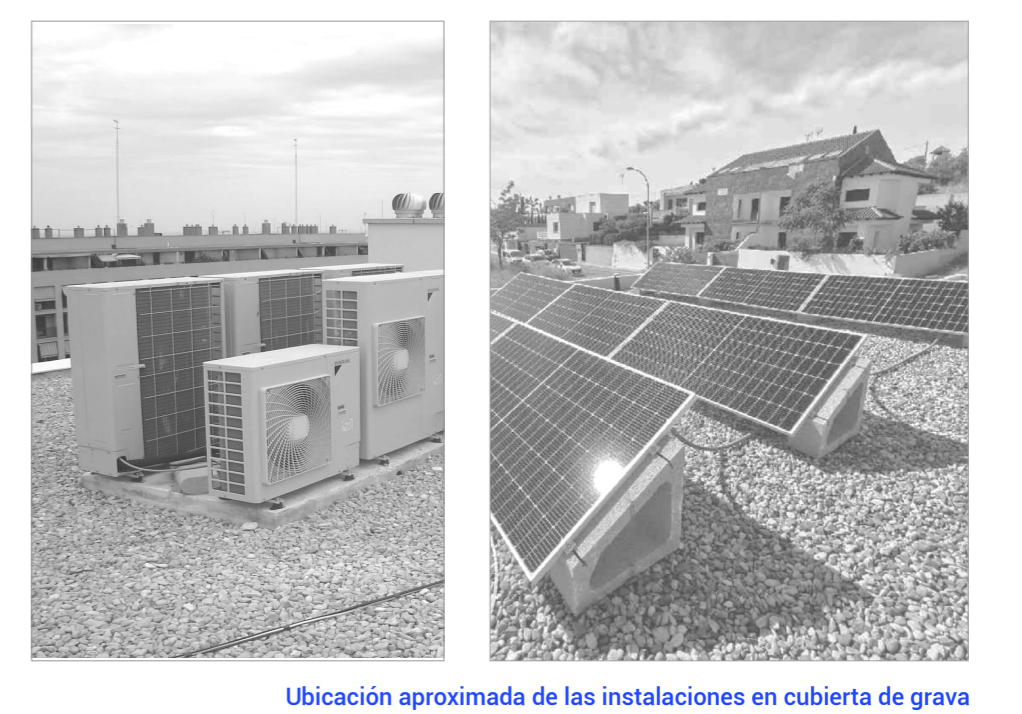
Ubicación aproximada de las instalaciones en cubierta de grava
