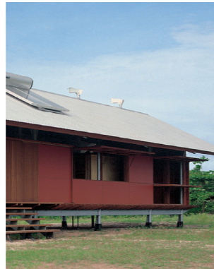
Figura 2.3.13. Placas solares y ventilación por chimeneas.
