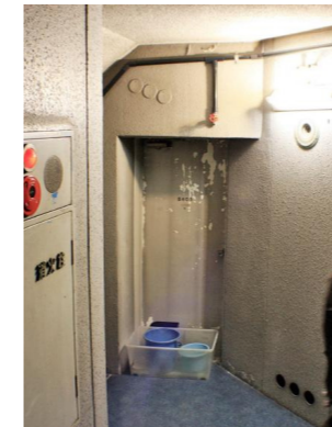
Figura 2.9.20. Estado actual interior de escaleras.
