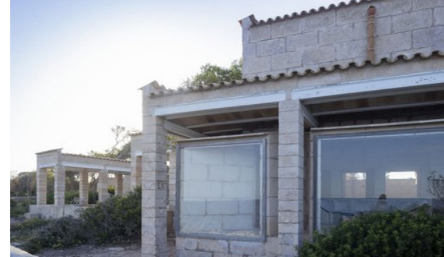
Figura 2.2.15. Imagen protecciones solares.
