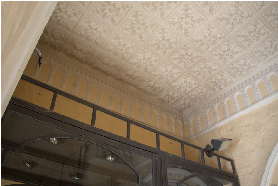
Parte superior del armario metálico de planta baja, y parte de la instalación eléctrica y molduras.
