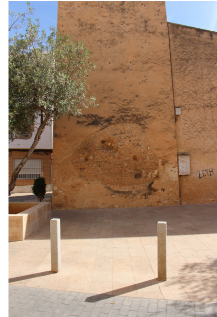
Detalle desconchado fachada calle Sanchís
