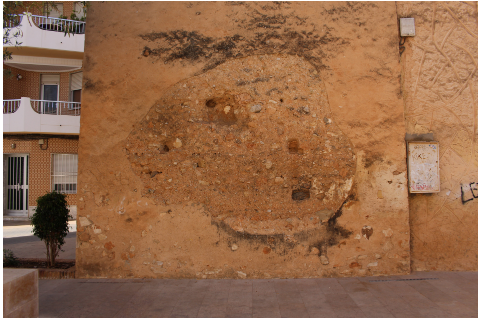
Detalle desconchado fachada calle Sanchís
