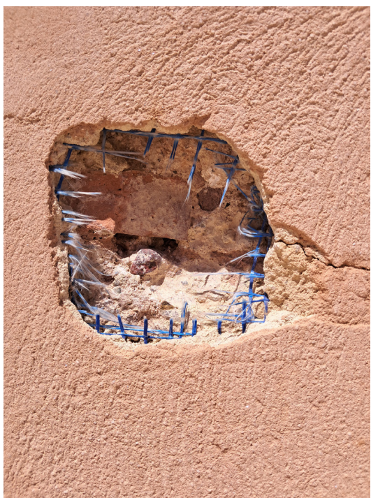
Figura 136. Desperfecto en el revestimiento de la fachada Este
