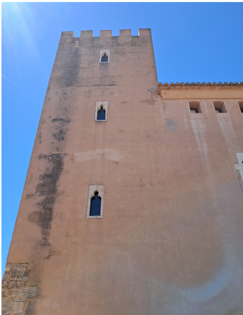
Figura 137. Humedades por escorrentía en la fachada Norte
