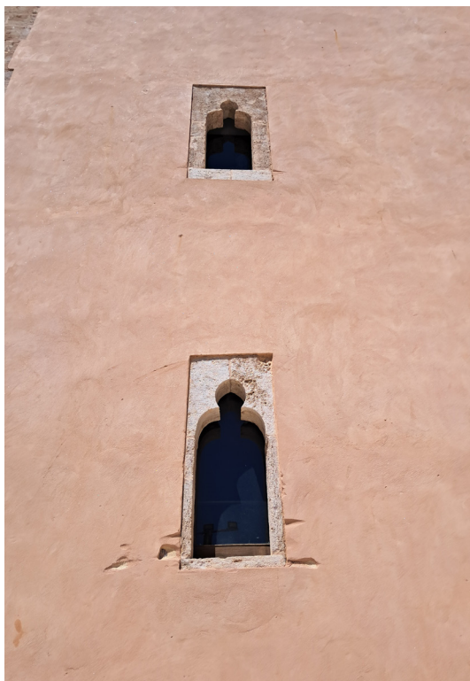
Figura 135. Desperfectos en el revestimiento de la fachada Este
