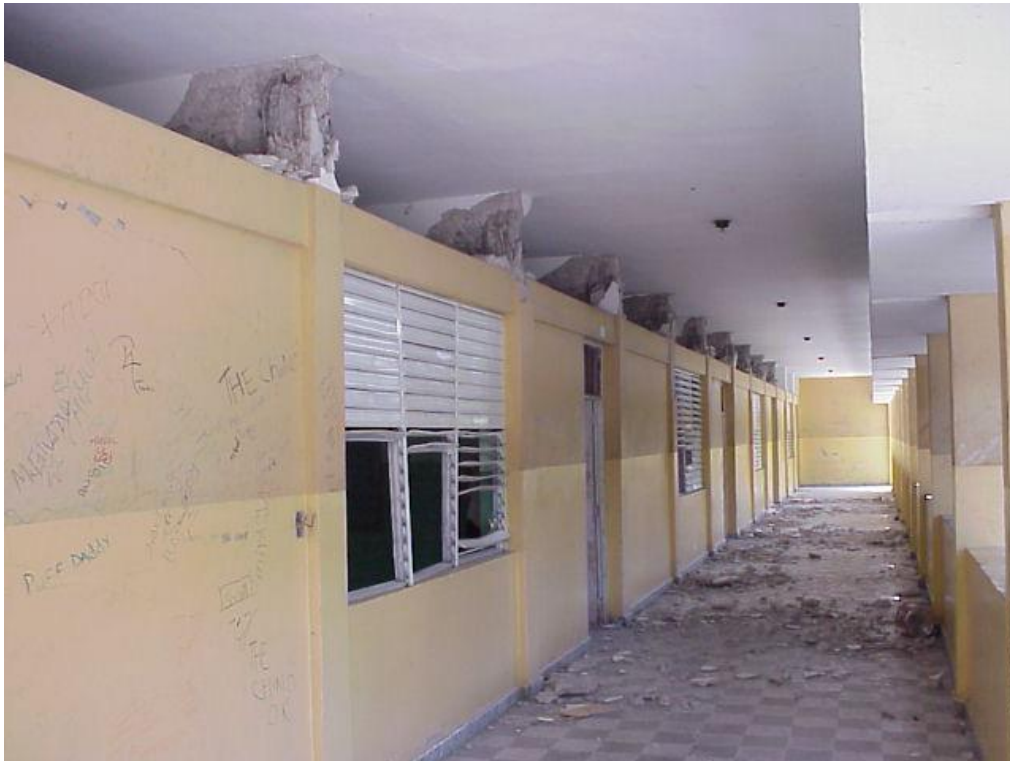
Figura 9: Escuela José Dubeau, deterioro de la conexión Viga-Columna. Fuente: López et al (2003).
