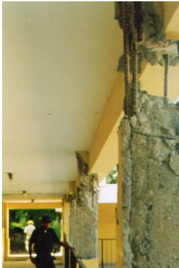
Figura 8: Escuela La Reforma, falta de aros, conexión Viga-Losa. Fuente: López et al., (2003).
