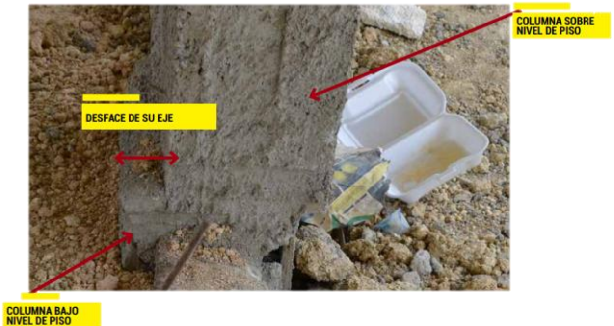
Figura 32: Escuela básica Marañón 1, desface de columna fuera de su eje bajo nivel de piso, efecto inaceptable sísmicamente. Fuente: Reyes (2015).
