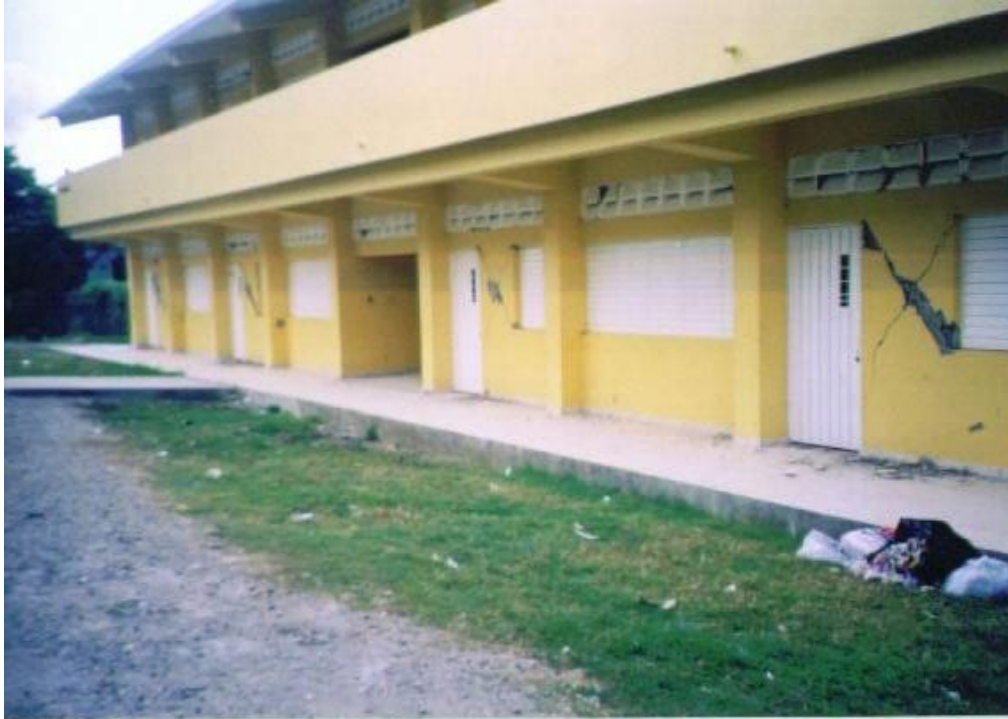
Figura 10: Escuela Concepción Gómez, daños en paredes de bloques, dirección longitudinal. Fuente: López et al (2003).
