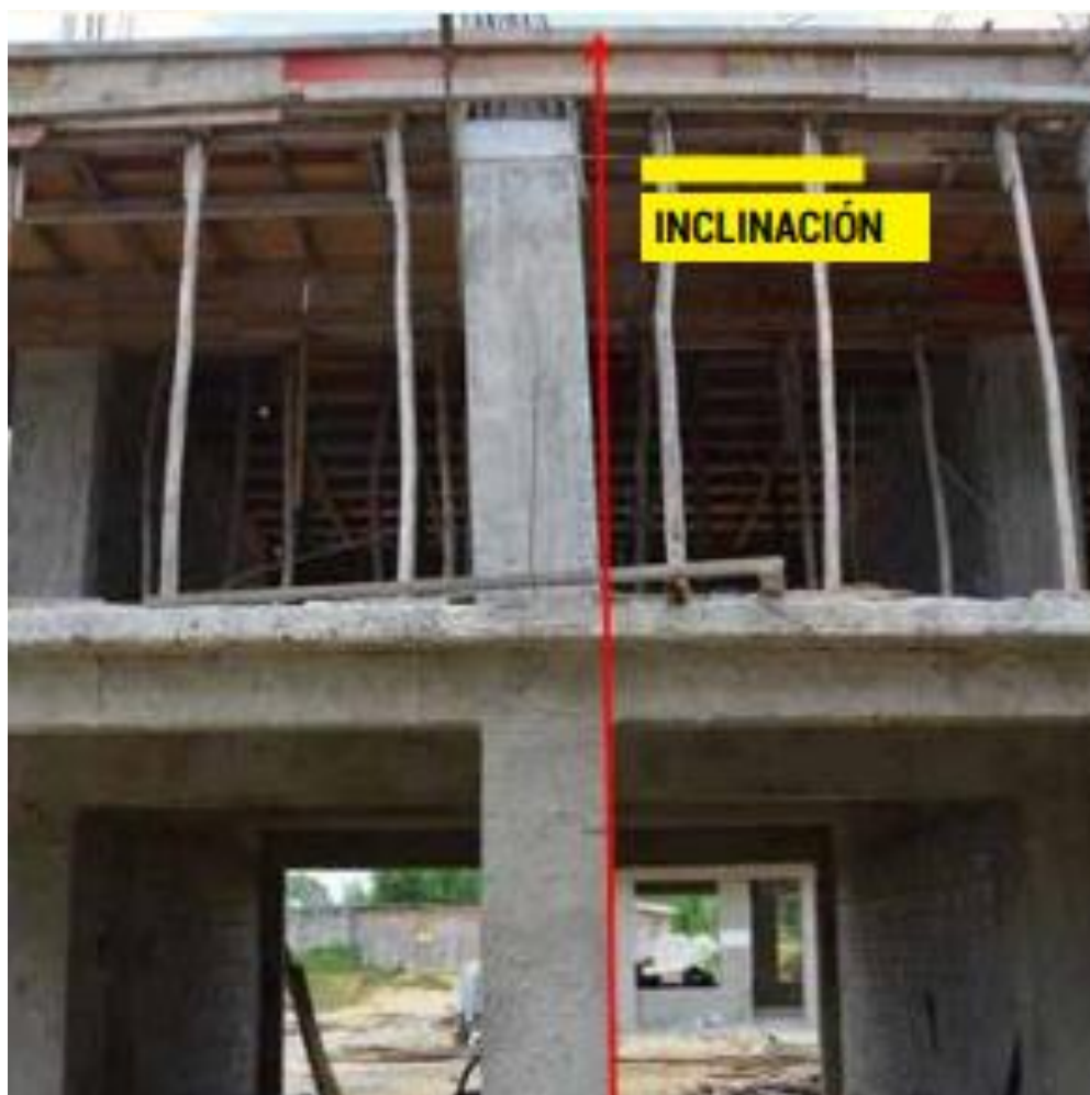
Figura 30: Escuela básica Marañón 1, inclinación inaceptable sísmicamente de una de las columnas del segundo piso. Fuente: Reyes (2015).
