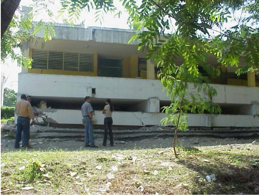
Figura 34: Escuela La Reforma, piso colapsado, terremoto Puerto Plata 2003. Fuente: López & Martínez (2003).
