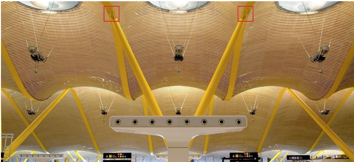
Imagen 108 | Uniones de los pilares en forma de "V" con las vigas principales. (Estudio Lamela)
