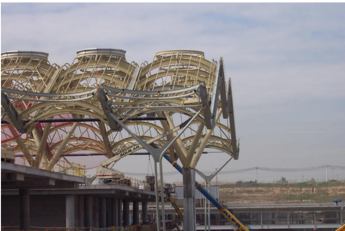
Imagen 26 | Vista exterior de la parte superior de la estructura de la terminal. (Horta Coslada)
