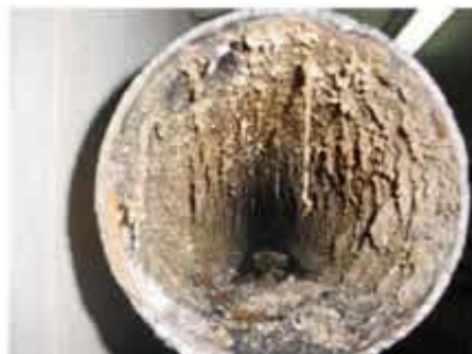
Figura 1.16 Incrustaciones de estruvita en la línea de fangos de la EDAR Murcia-Este
