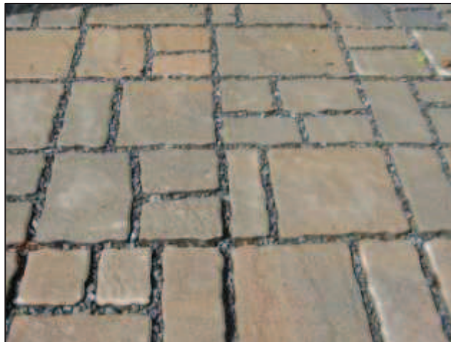
Figure 17.- Permeable pavement. ( www.jesuispauvre.com )
