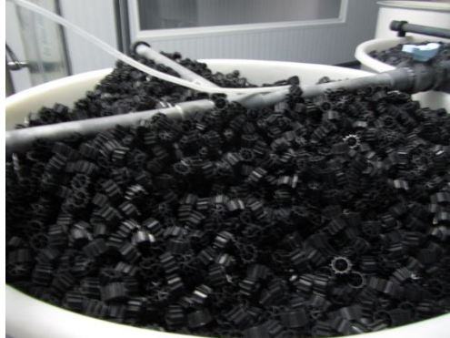
Figura 20. Vista superior del biofiltro.
