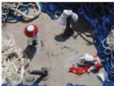
Fotografía 12: Perforación de las protecciones tras el impacto.
