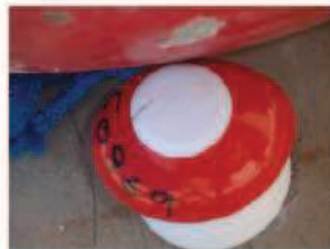
Fotografía 11: Detalle de las protecciones tras el impacto.
