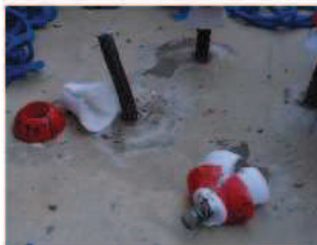
Fotografía 15: Perforaciones totales y roturas longitudinales de las protecciones
