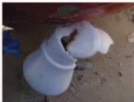
Fotografía 13: Detalle del estado de una de las protecciones que ha sufrido el impacto
