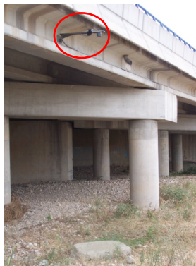
Figura 4-2. Sensor para la medición de caudal del SAIH-CHJ en la Rambla del Poyo - Puente de la A3 (cuenca de aportación 189 km 2 ).
