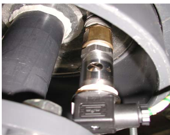
Figura 3.15.- Detalle de instalación de medidores de presión.
