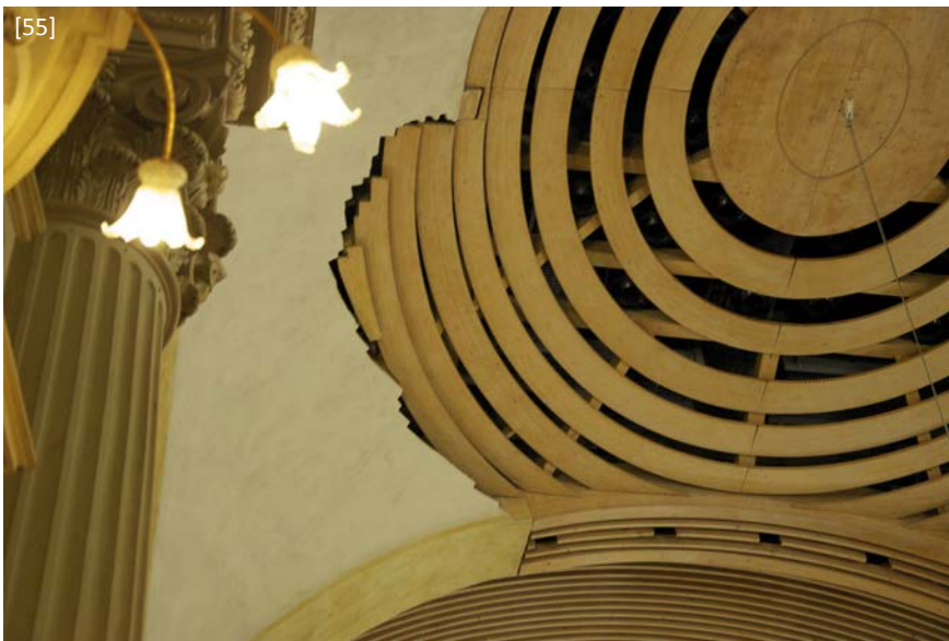
[55] Detalle del encuentro entre la nueva bóveda y la parte que sobrevivió al bombardeo. (Imágenes del autor)
