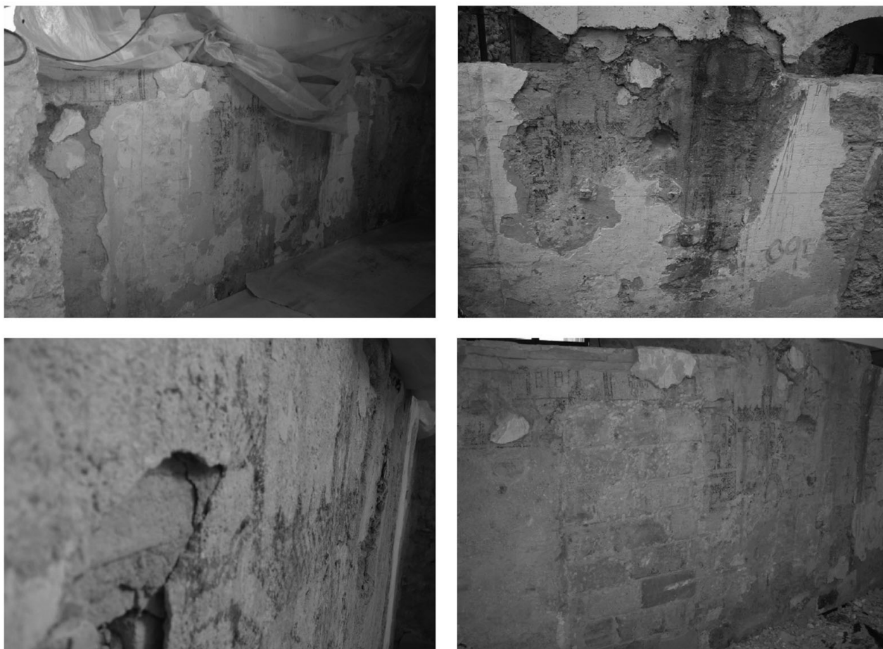
Figura 7. De dalt a dreta i de baix a dreta; es percep l'estat de conservació abans de la restauració, on podem apreciar la descohesió del morter, la descohesió entre estrats i els accessos fets al mur
