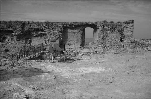
Figura 3. Estado del muro Oeste antes de la intervención en su cara interior
