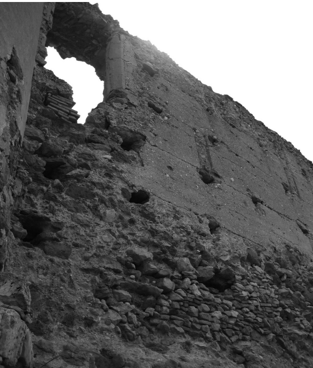
Figura 5. Detalle del estado del muro Oeste antes de la intervención en su cara exterior
