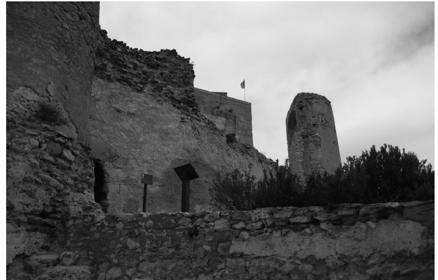
Figura 6. Estado del muro Sur antes de la intervención en su cara exterior
