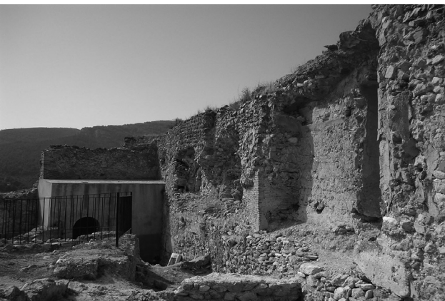
Figura 4. Estado del muro Oeste antes de la intervención en su cara interior
