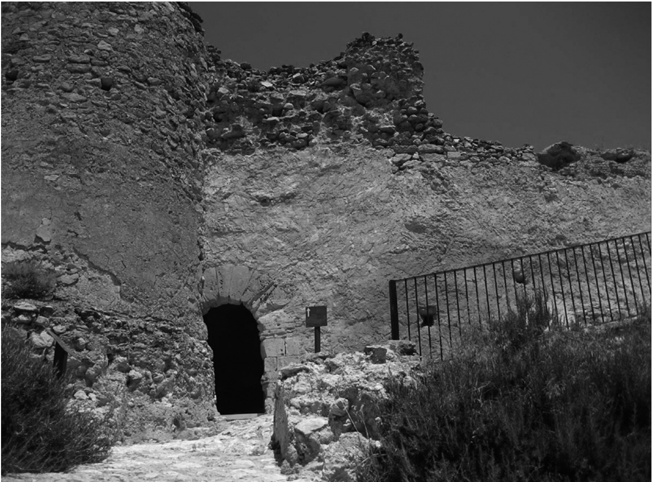
Figura 9. Lienzo Sur de la muralla interna antes de la intervención en su cara exterior
