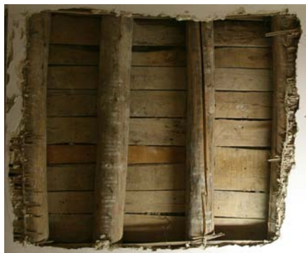
Fenda longitudinal en vigueta de rollizo de chocho detectada en una cata de forjado. Palacio de las Columnas, Granada.
