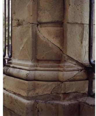
Fisuras en una pilastra de la verja de la Catedral de Jaén.
