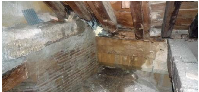
DETECCIÓN DE FILTRACIONES CONTINUADAS DEBIDAS AL AGUA DE LLUVIA EN EL INTERIOR DE LA CUBIERTA. CATEDRAL DE GRANADA.
