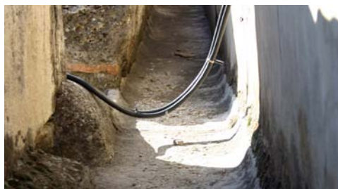
Tendido eléctrico atravesando una canal. Catedral de Granada.
