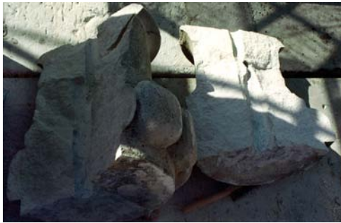
Base de pináculo fracturada en dos partes
