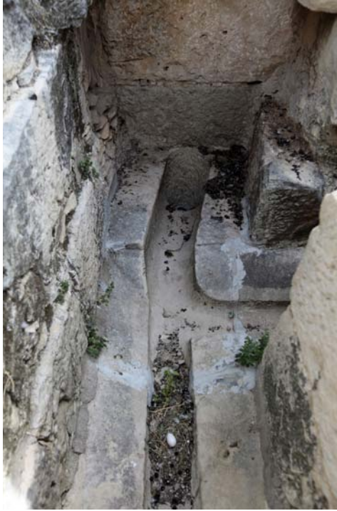
Entrada a una de las bajantes embutidas en contrafuertes con escaso mantenimiento. Catedral de Jaén.
