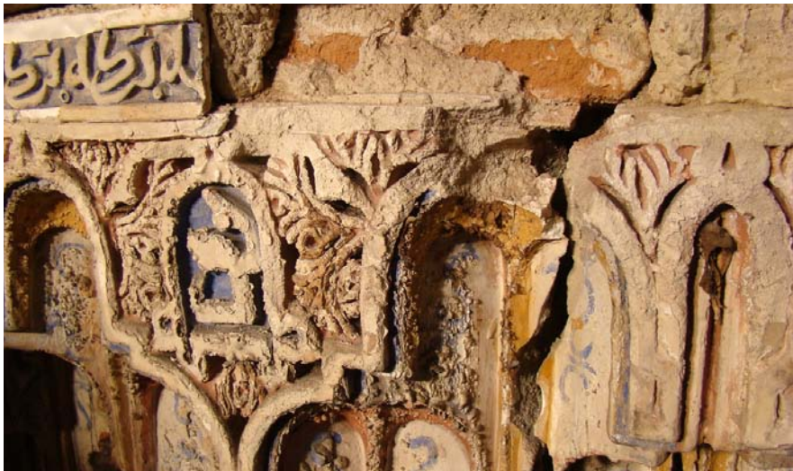
Estado de las yeserías antes de la intervención.
