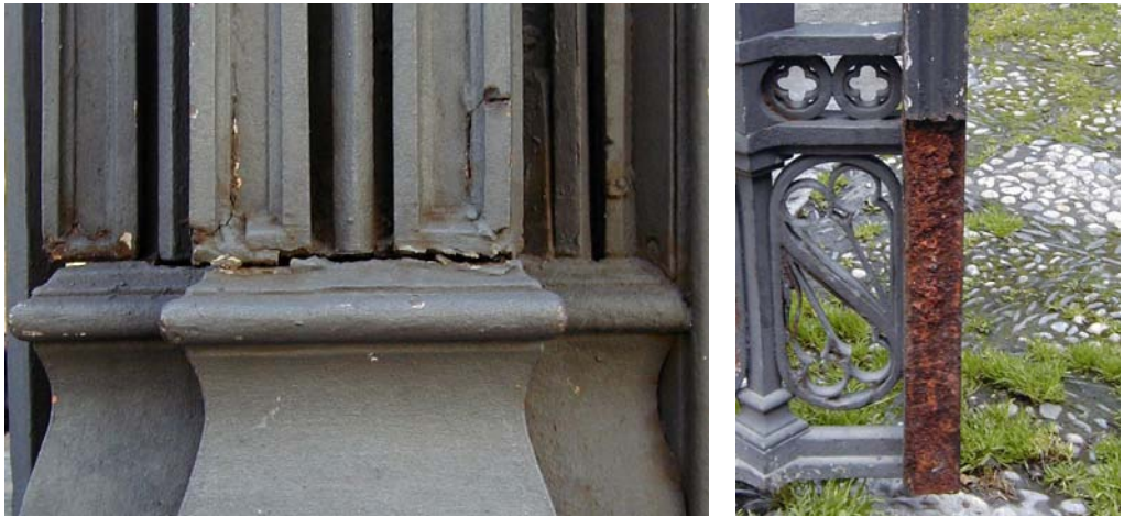
Elementos metálicos afectados por acciones mecánicas y oxidación en una verja compuesta por materiales de escasa sección. Verja (s. XX) de las calles Oficinos y Gran Vía, Granada.
