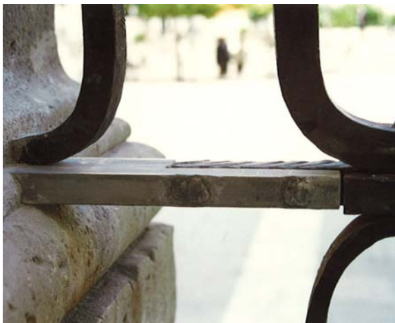
Sustitución de la pletina inferior y roblones por otros elementos de acero inoxidable en bruto. Verja de la Lonja. Catedral de Jaén.
