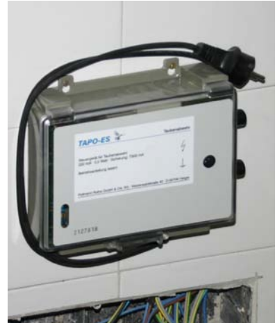
Estación de control del sistema electrostático de rechazo de aves del Palacio de la Madraza, Granada.
