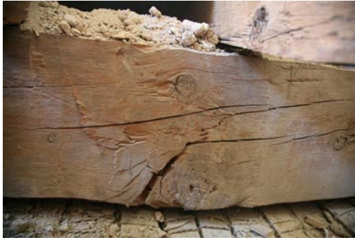
Rotura de viga de forjado debido a las cargas, morfología de la madera (presencia de nudos) y fendas longitudinales. Palacio de las Columnas, Granada.
