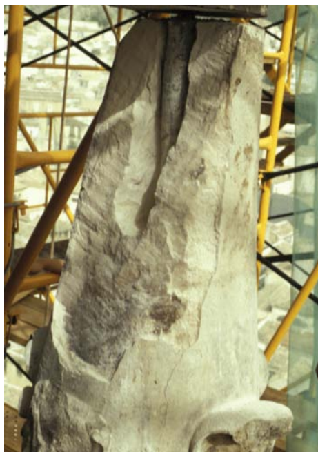
Rotura lineal de pináculo. Catedral de Jaén. El vástago de anclaje aparece en la parte superior. La rotura es limpia y se debe a efectos mecánicos.
