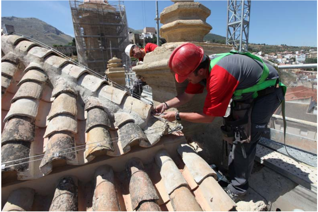
Colocación de sistema electrostático de rechazo de aves en la Iglesia de San Gabriel de Loja (Granada).
