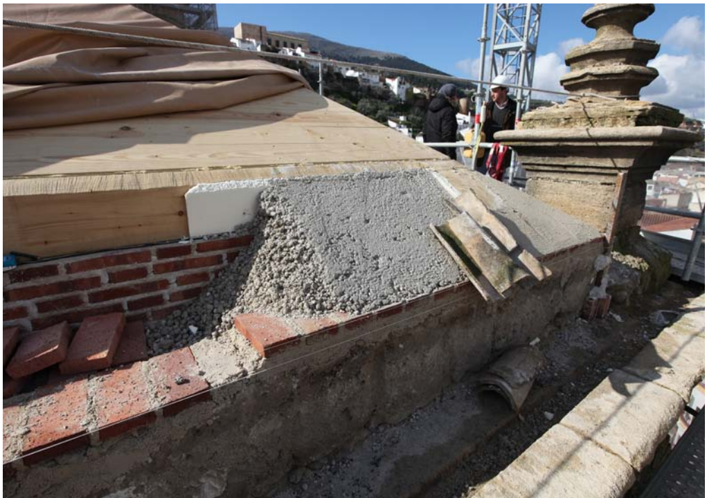
Relleno de mortero de cal hidráulica y arcilla expandida. Se observa la colocación de una pieza de poliestireno expandido para su separación del durmiente. Esta pieza se retira una vez iniciado el fraguado. Iglesia de San Gabriel de Loja.
