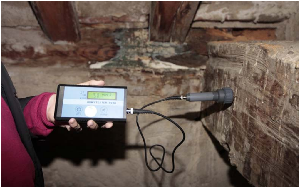
Medida de humedad en un tirante en contacto con el durmiente afectado (15,8). Catedral de Granada.
