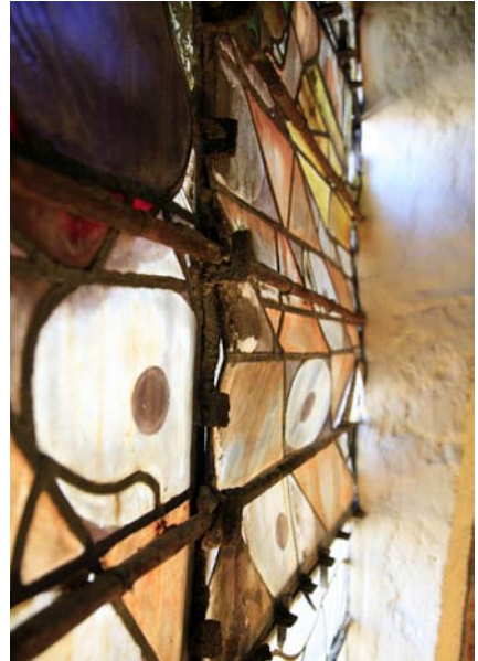
Deformación de paño de vidriera hacia el interior. Catedral de Granada
