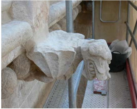
Gárgola fracturada parcialmente
