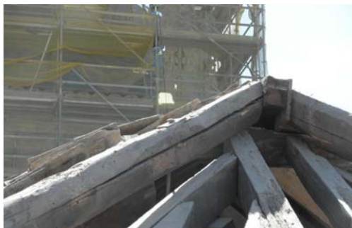
Fenda longitudinal en una lima. Hospital Real, Granada
