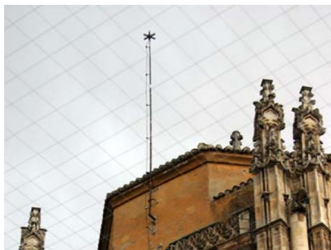
Pararrayos. Cimborio del Hospital Real, Granada.
