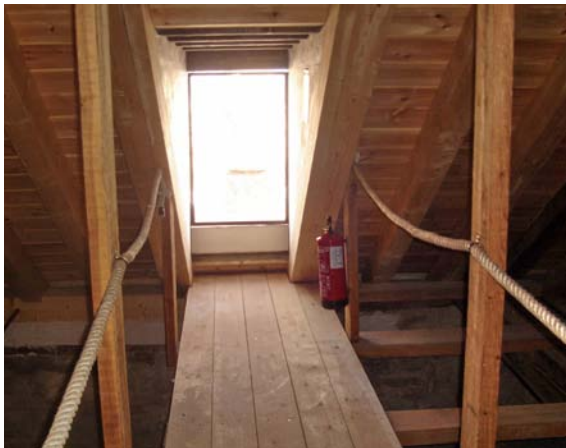
Extintores en el interior de la estructura de madera. Pabellón P5 Catedral de Jaén.
