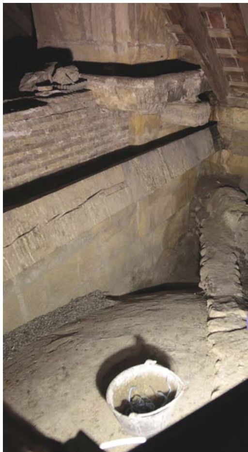
Remoción del material de relleno en el seno de una bóveda afectada por la humedad para producir el desecado de los aportes y aminorar el tiempo de recuperación de la zona afectada.
