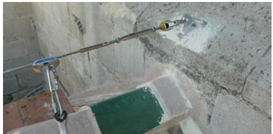
Línea de vida con dispositivo de amortiguamiento en caso de caída. Hospital Real de Granada.
