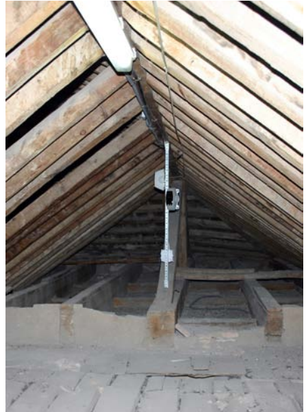
Sistema de detección de incendios. Palacio de las Columnas, Granada.
