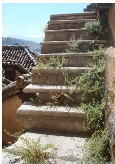
Escalera exterior de acceso a cubierta con ausencia de protecciones y crecimiento incontrolado de vegetación. Catedral de Granada.
