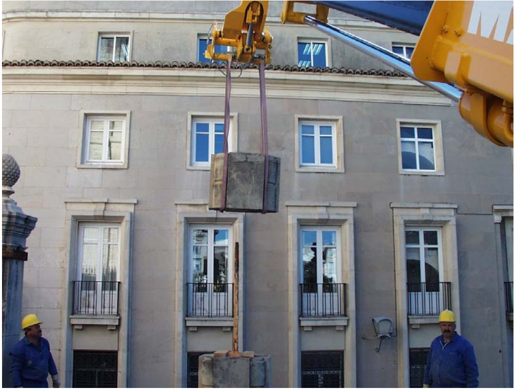
Operación de desmontaje de una pilastra con grúa. Verja de la Lonja. Catedral de Jaén.
