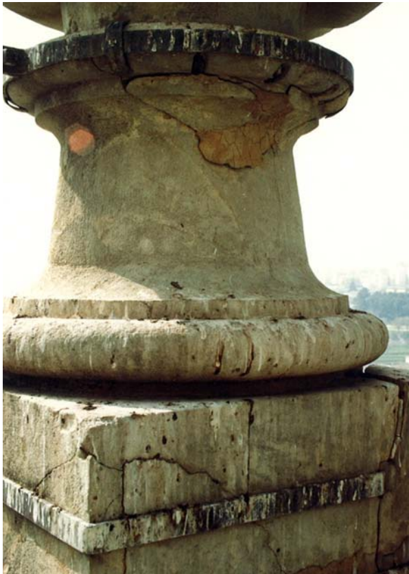
Fisuras provocadas en la basa de un pináculo por la oxidación de grapas y anclajes metálicos superficiales. Catedral de Jaén
