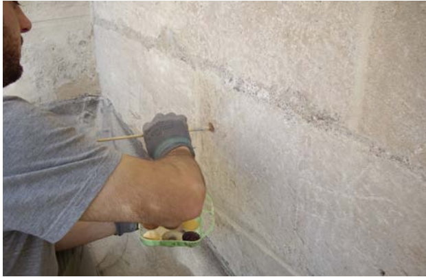
Patinado de mortero en la Capilla Real, Granada.
