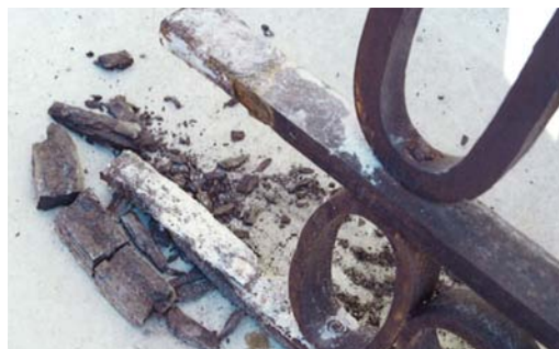
Alteración de partes de reja en contacto con la piedra donde se acumula la humedad. Verja de la Lonja. Catedral de Jaén.
