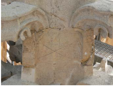
Parte dañada de un pináculo
