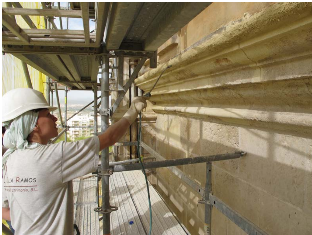
Regado de mortero de cal hidráulica para consolidación de cornisa de piedra. Hospital Real de Granada
