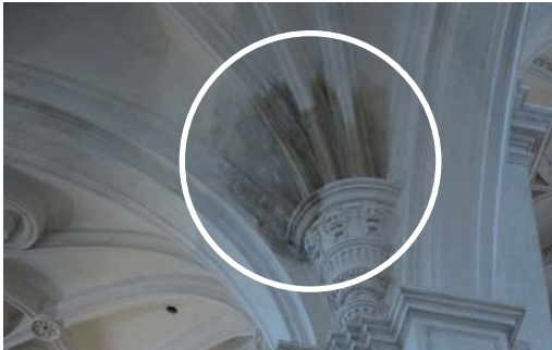
Mancha general producida por filtración en el arranque de una bóveda. Catedral de Granada.
