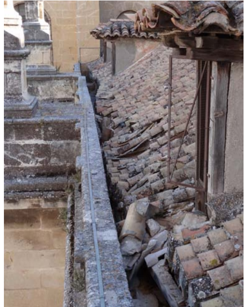
Deformación de alero por deslizamiento del paño de tejas. Catedral de Granada.
