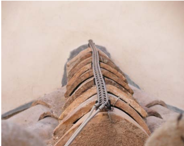
Detalle del sistema electrostático antipalomas colocado en la cumbre de un paño de cubierta del Hospital Real, Granada.
