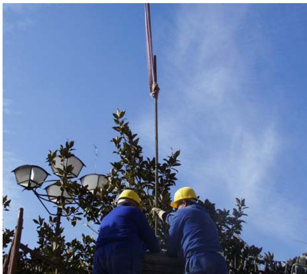
Colocación de vástago central de acero inoxidable. Verja de la Lonja. Catedral de Jaén.
