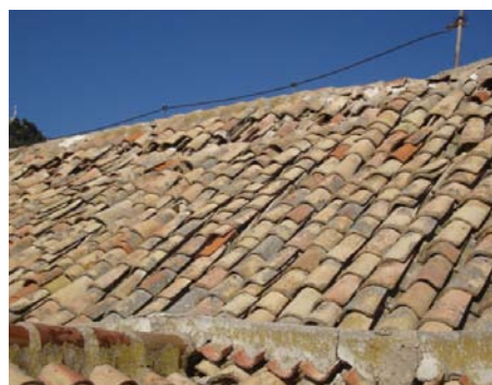
Tejas desplazadas por el viento, inclinación de la cubierta y deformaciones de la estructura. Catedral de Jaén.
