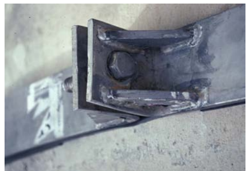
Tramos de zuncho sobre banda de neopreno dispuestos para ajustar y tensar.
