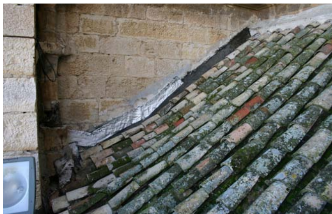
Encuentro del faldón de las cubiertas laterales con el muro. El material de impermeabilización no es continuo. Catedral de Jaén.
