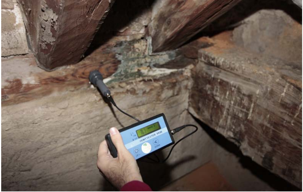
Medida de humedad en un durmiente afectado (78,3). Catedral de Granada.
