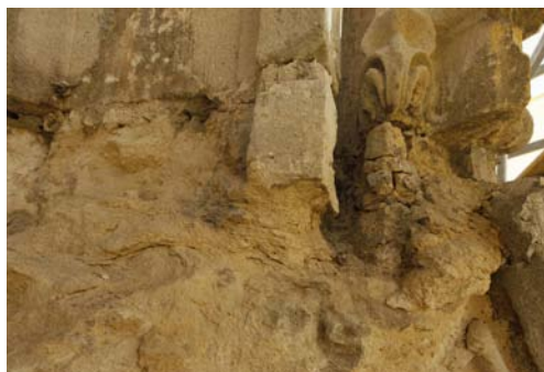
Piedra disgregada y con adición de cementos en un pináculo. Hospital Real, Granada.
