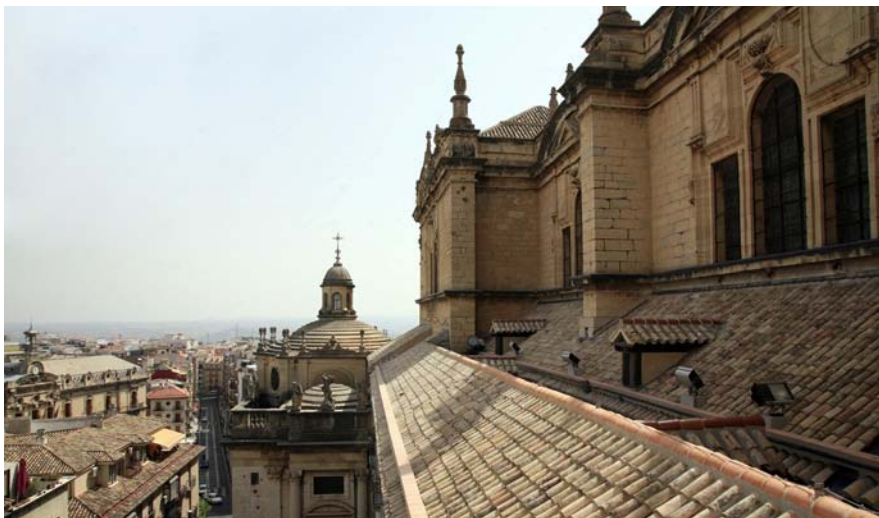
Cubierta lateral de la calle Campanas tras la intervención de 2011-2012. Catedral de Jaén.
