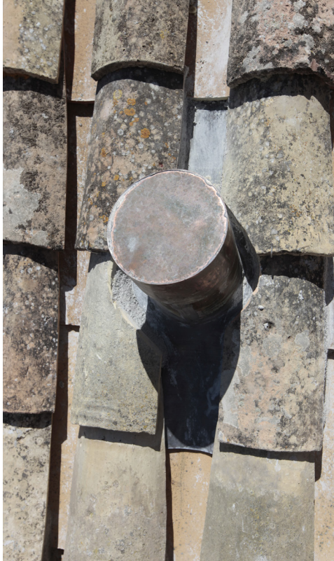
Registro para inspección y manipulación de una de las bajantes ocultas después de la intervención. Cubiertas de la C/ Campanas. Catedral de Jaén.
