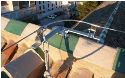
Línea de vida con continuidad en el cambio de dirección de la cumbrera. Hospital Real de Granada.
