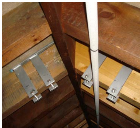
Pletinas de anclaje de la línea de vida a los pares de cubierta.
