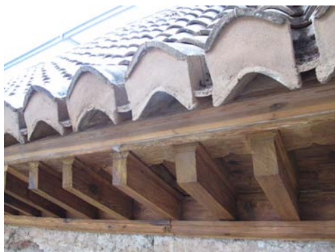
Alero de teja sobre canecillos de madera. Estos últimos presentan una inclinación pronunciada respecto al plano de fachada. Sala de los Reyes. Palacio de Los Leones de la Alhambra.
