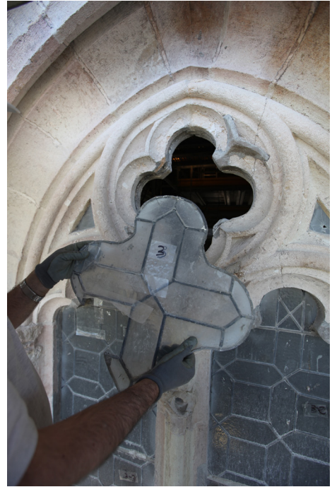
Retirada de las vidrieras encastradas del Címborio del Hospital Real desde el andamio de obra.
