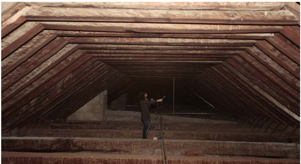
Toma de datos en el interior de cubierta afectada por filtraciones. Catedral de Granada.
