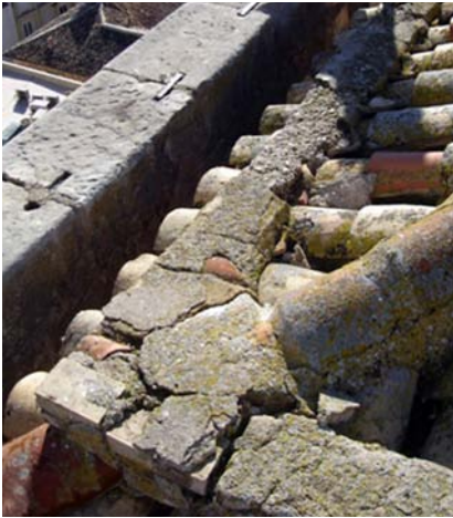
Pasarela de mantenimiento en mal estado. Catedral de
