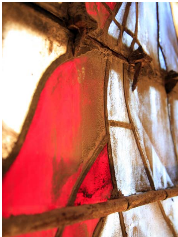
Corrosión de plomo de las vidrieras de la Catedral de Granada.
