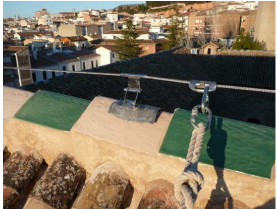
Línea de vida en cumbrera con sistema de corredera continua en apoyos. Hospital Real de Granada.
