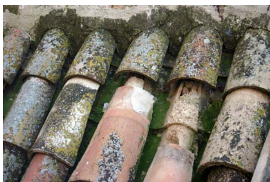
Tejas desplazadas por un deslizamiento importante de todo el paño. Catedral de Granada.
