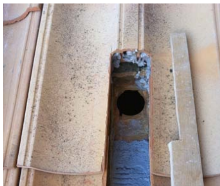
Detalle del hueco para la entrada del cernicalo practicado en material especial de cobertura (pieza cerámica prefabricada).
