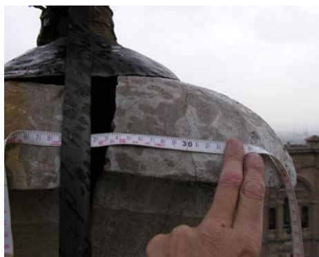
Fractura en la base de la veleta de la Catedral de Granada, debida a las oscilaciones que el viento introduce a través del anclaje.
