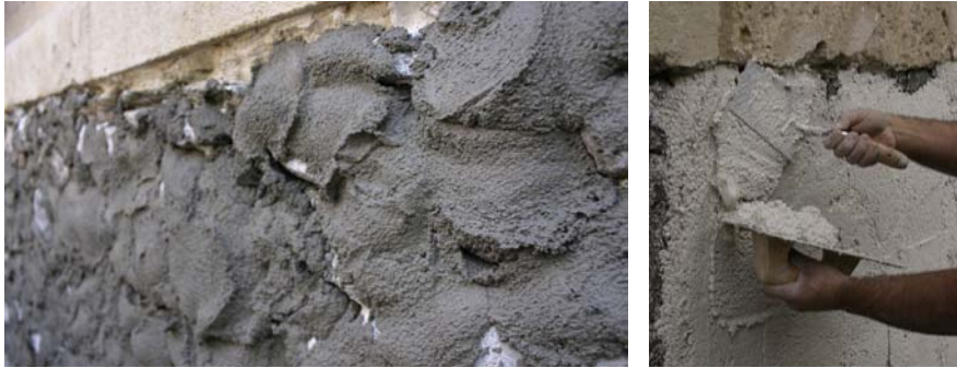
Textura de mortero base anti-humedad y aplicación de mortero en fase previa a la de acabado. Zócalo de la iglesia de Santo Domingo, Granada.
