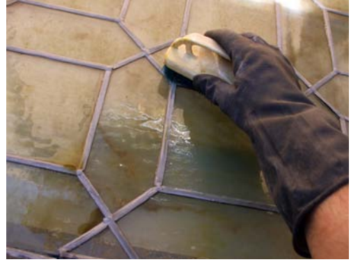
Limpieza en taller de uno de los paneles de vidriera con cepillo de cerdas y agua.
