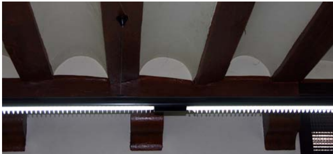
Torsión de viguetas de forjado. Palacio de las Columnas, Granada.
