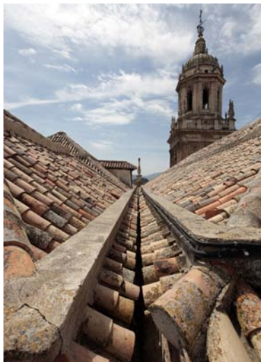
Canal con espacio insuficiente para el mantenimiento. Catedral de Jaén.
