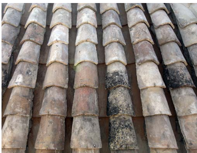
Vista frontal de paño de tejas con ganchos de acero inoxidable. Hospital Real de Granada.
