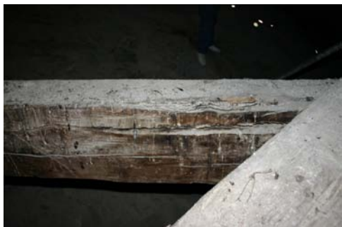
Fendas longitudinales en un tirante. Catedral de Jaén
