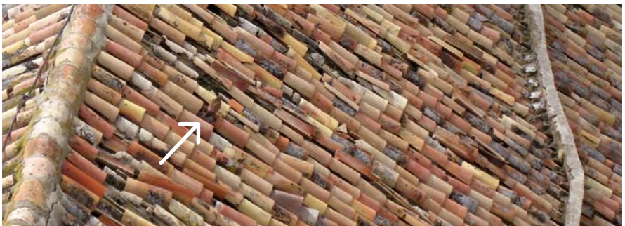
Cernicalo primilla en un páño de cubierta antes de la intervención. Catedral de Jaén.
