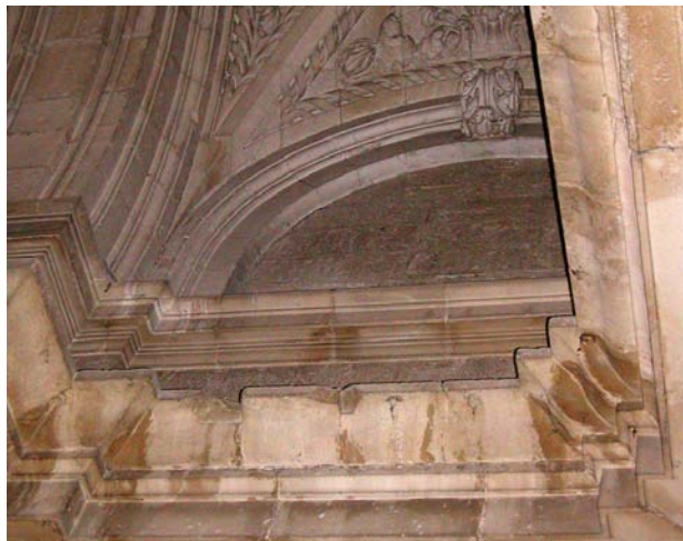
Filtraciones de agua. Catedral de Jaén.
