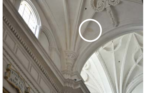
Mancha en la superficie inferior de la bóveda producida por una filtración puntual. Catedral de Granada.
