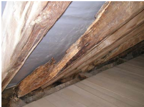
Par con pérdida de sección importante. Catedral de Jaén
