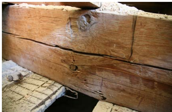
Fenda longitudinal en viga de forjado. Palacio de las Columnas, Granada.
