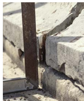
Desplazamiento del apoyo de la cúpula. Torre derecha. Catedral de Jaén.
