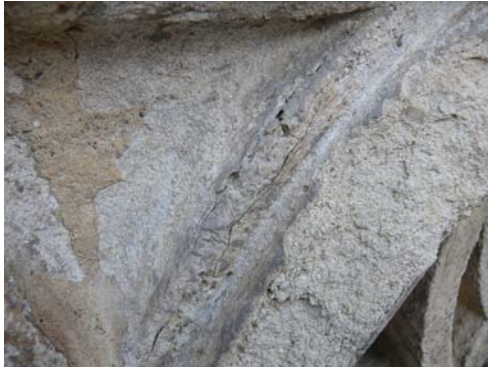
Fisuras en piedra tallada.
