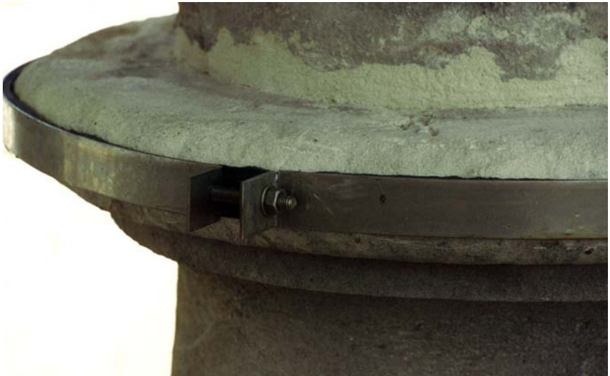
Detalle de zunchado con acero inoxidable y neopreno en un pináculo. Intervención 1991-92. Catedral de Jaén.
