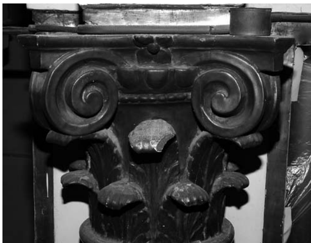
Figura 6. Estado inicial de los capiteles de las tribunas.
