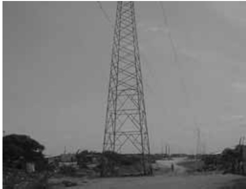
Tendido eléctrico zona norte
