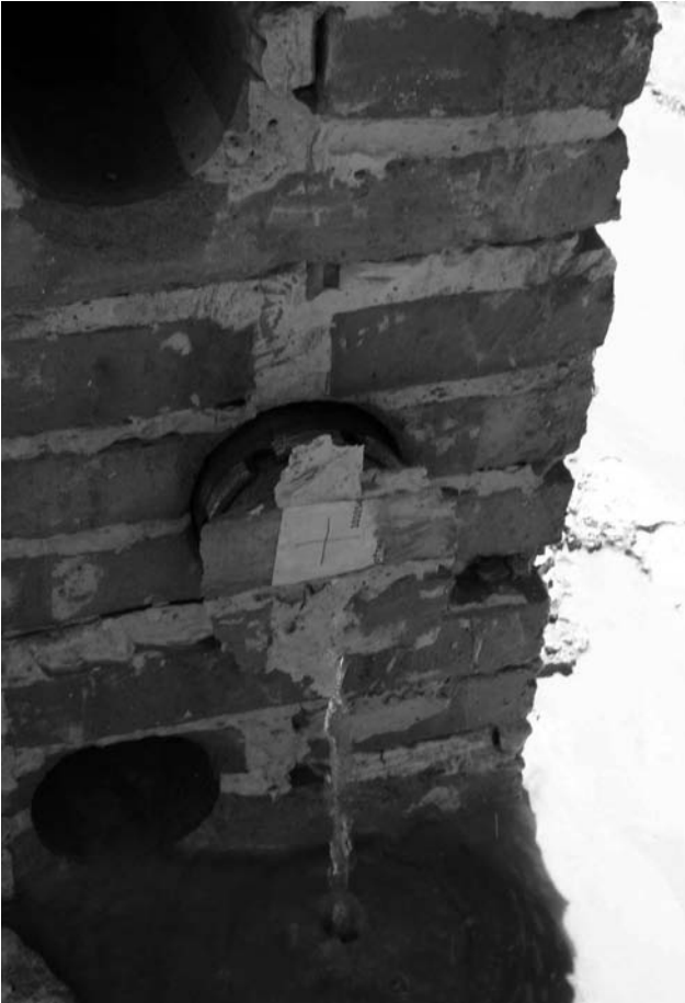
Imagen 5 Fin de la última prueba con salida del taladro por el punto previsto. Se pueden ver otras perforaciones diseñadas en pruebas anteriores.
