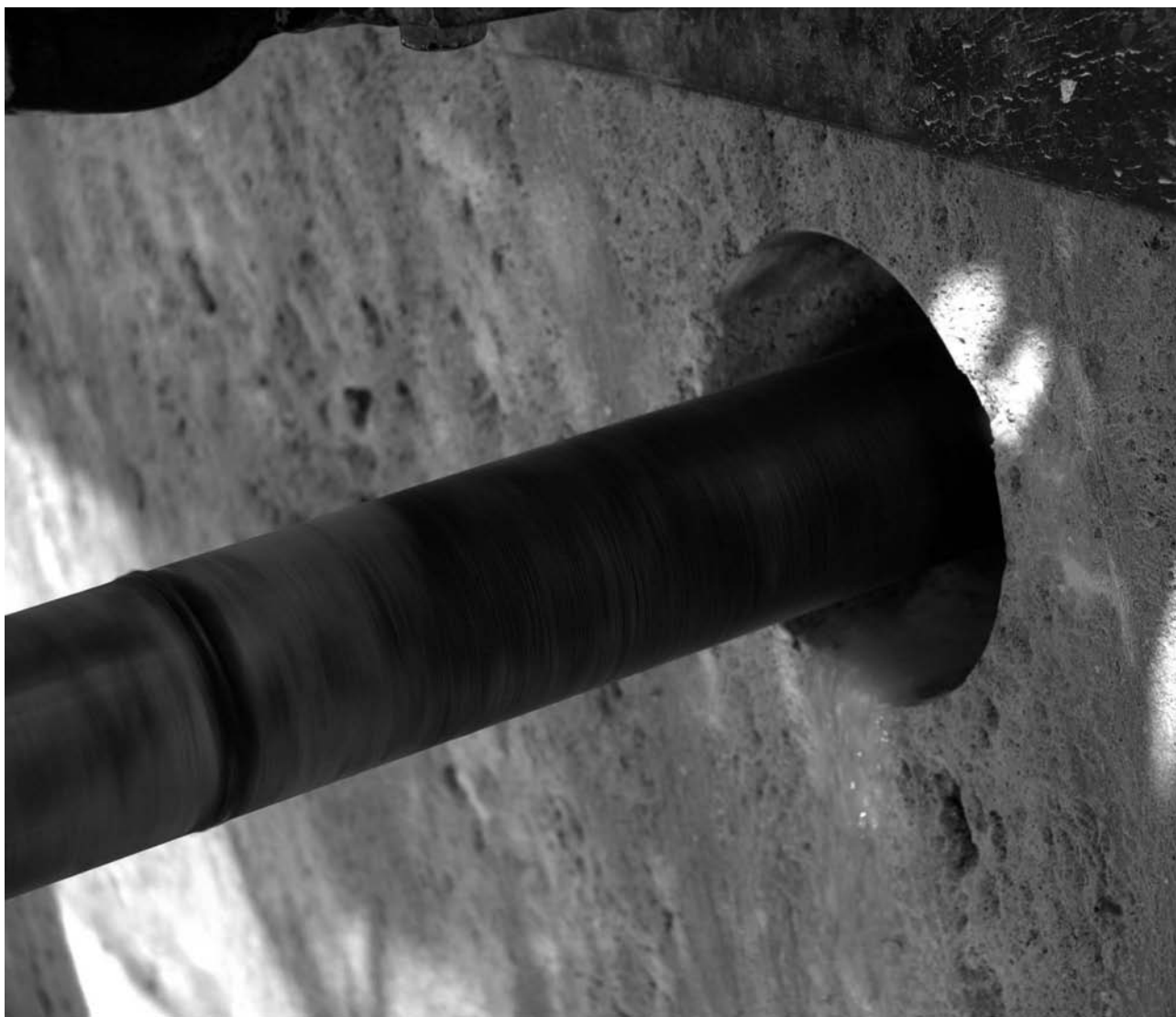
Imagen 8 Perforación en el puente.
