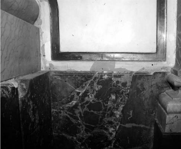
Figura3. Alteraciones del zócalo debidas a los cambios térmicos.
