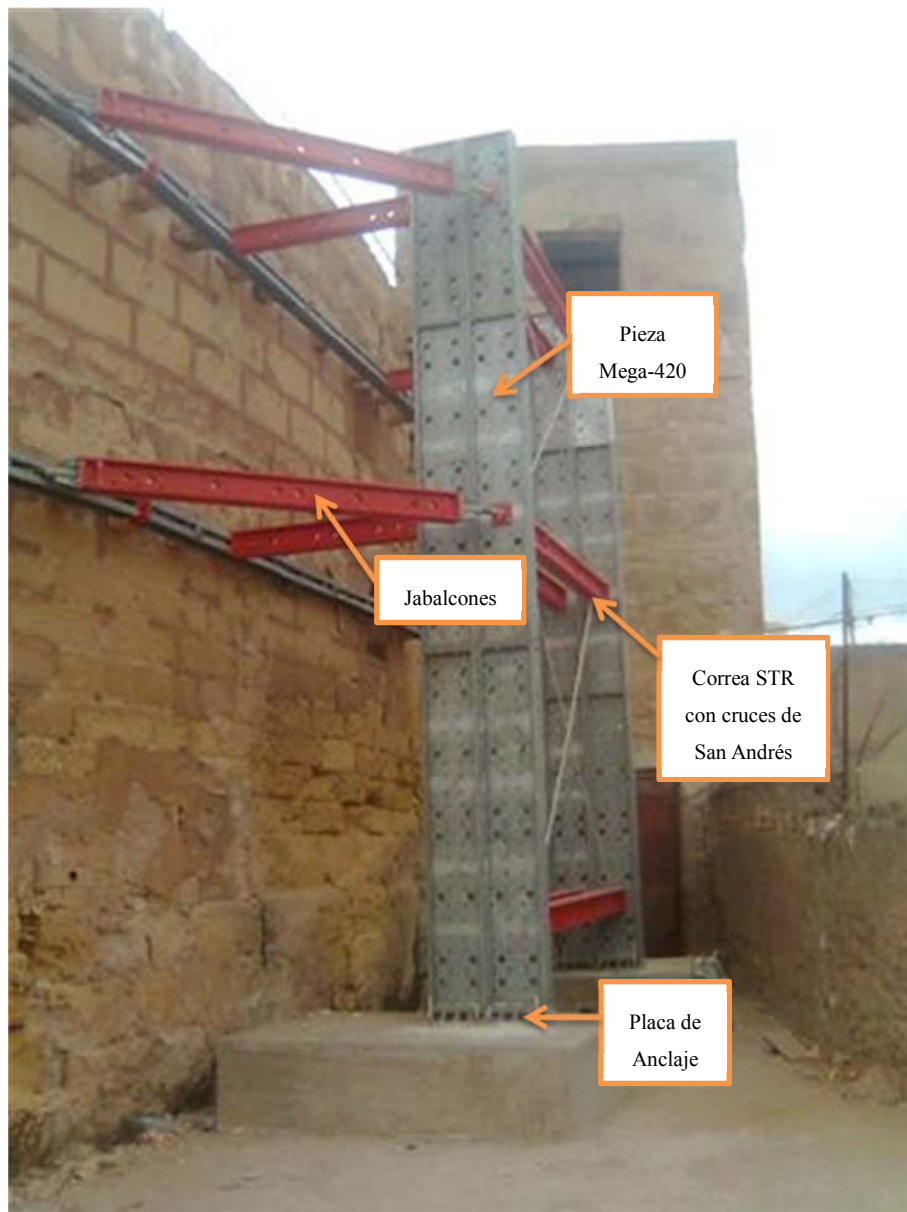
Zona de estructura a base de Megs-420 (Fotografía 20)
