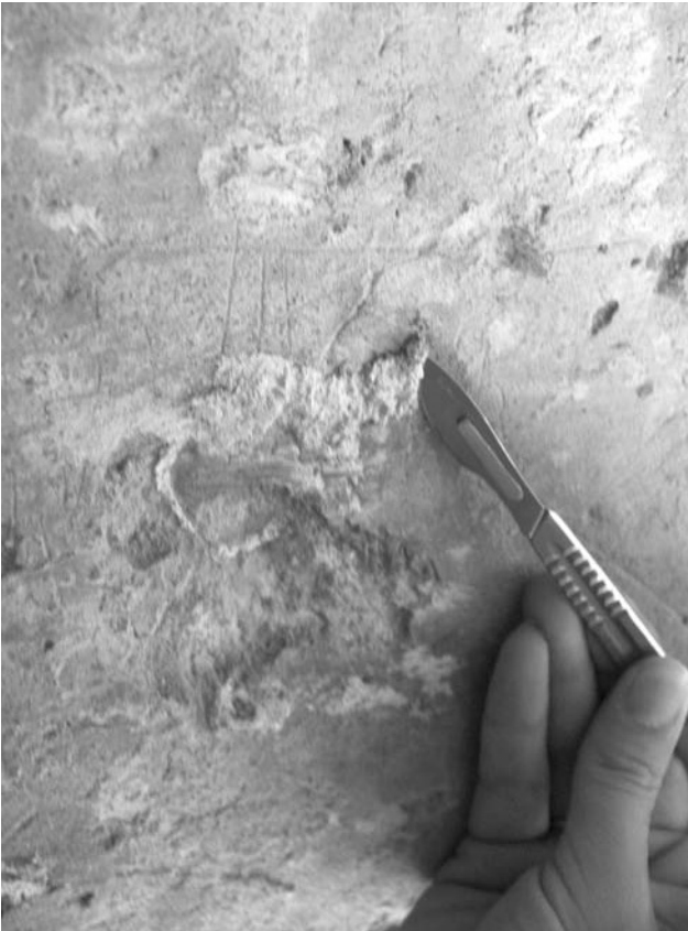
Figura 9. Eliminación mecánica de las concreciones de tipo calcáreo
