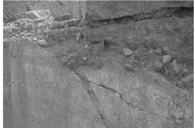
Figura 2 : Detalle del estado inicial de las estructuras con acumulación
