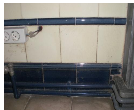
Fig. 1. Tuberías de calefacción existentes
