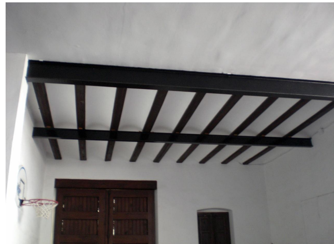
Figura 27. Vista del forjado del altillo y sala de juegos desde el garaje-almacén
