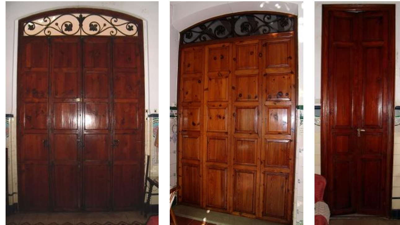
Fig. 14. Puerta salón-comedor (P2) Fig. 15. Puerta comedor-salón (P2) Fig. 16. Puerta acceso baño1 (P6)
