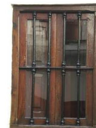
Fig.10. Vent. escalera-patio (VE5)
