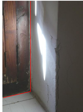
Figura 1. Vista de jamba en mal estado y del sellado a realizar
