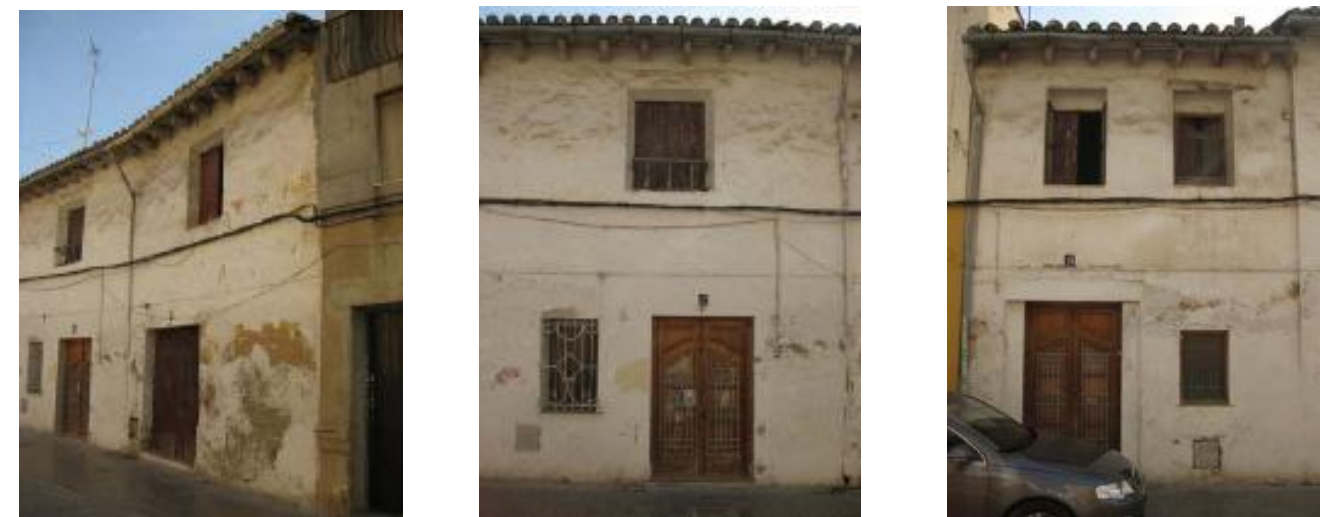
Figuras 2, 3, 4, 5 y 6. Vistas de algunas viviendas en mal estado de mantenimiento y conservación
