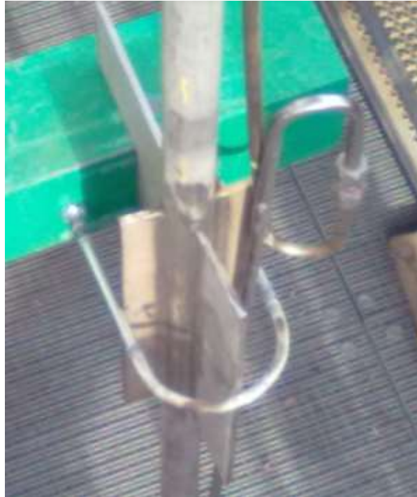
Soporte mediante abarcón, aletas guía y talón de apoyo en línea de inoxidable.
