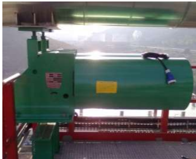
Apoyo sobre muelle calibrado de línea calorifugada.
