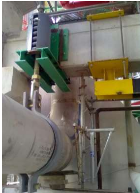
Soporte mediante muelle colgado y soporte invertido anclado.
