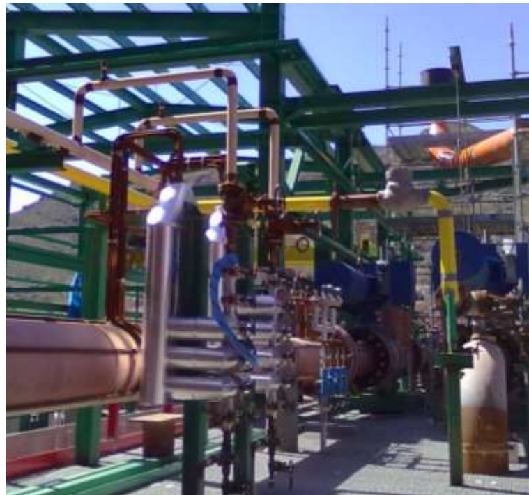
“Manifold” calorifugados traceando línea de carbono.
