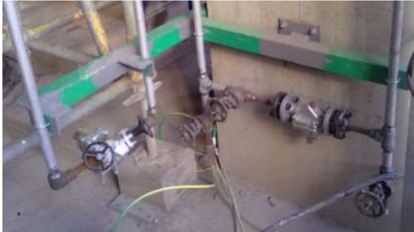
Purgadores de alta y baja presión para trampas de vapor y soportación común.
