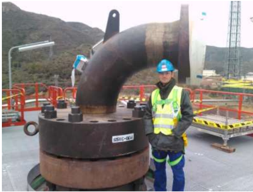
Revisión del estado del codo de 90º bridado remate de los reactores.
