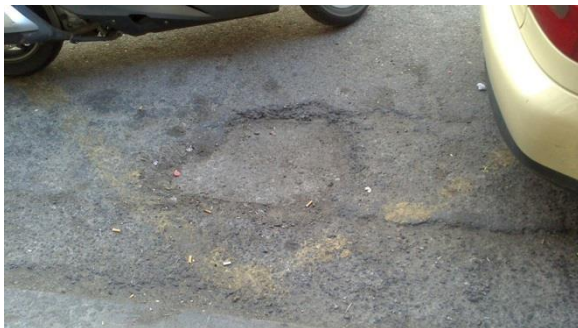
Imagen nº189. Socavón en la calle Poeta Altet.
