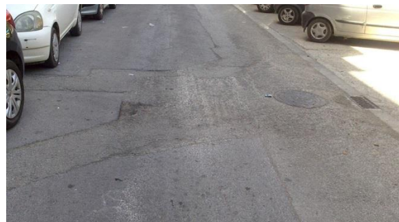
Imagen nº192. Parcheado mal ejecutado en la calle Poeta Altet
