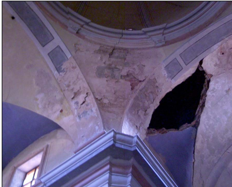
Figura 63: Soporte nº 3 izquierdo. Parte superior, efectos de las goteras.
