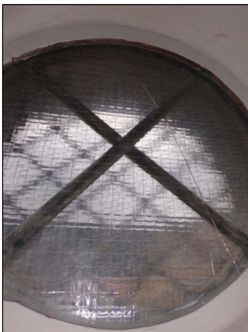
Figura 96: Rotura del cristal del óculo izquierdo interior (08-04-2013)
