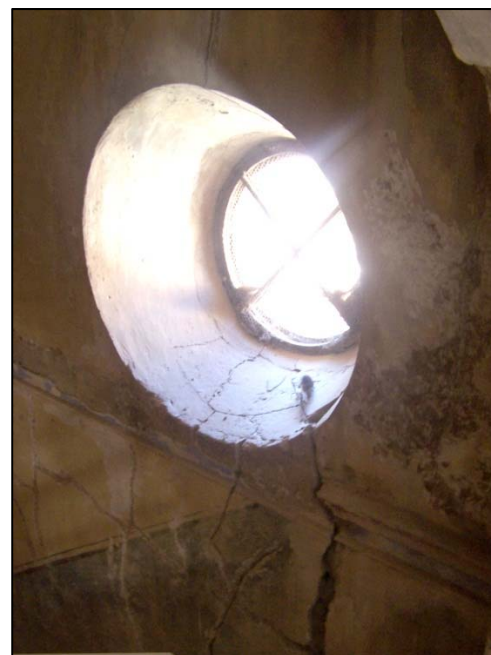
Figura 97: Estado del óculo antes de la restauración (04-09-2008) (José Torrent Martínez)
