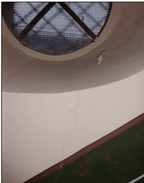
Figura 94: Grieta en el óculo izquierdo interior (08-04-2013)
