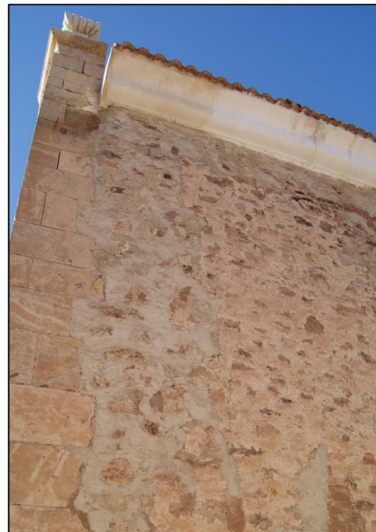
Figura 67: Reparación de la grieta que muestra cómo se separó la fachada principal de la fachada lateral derecha.
