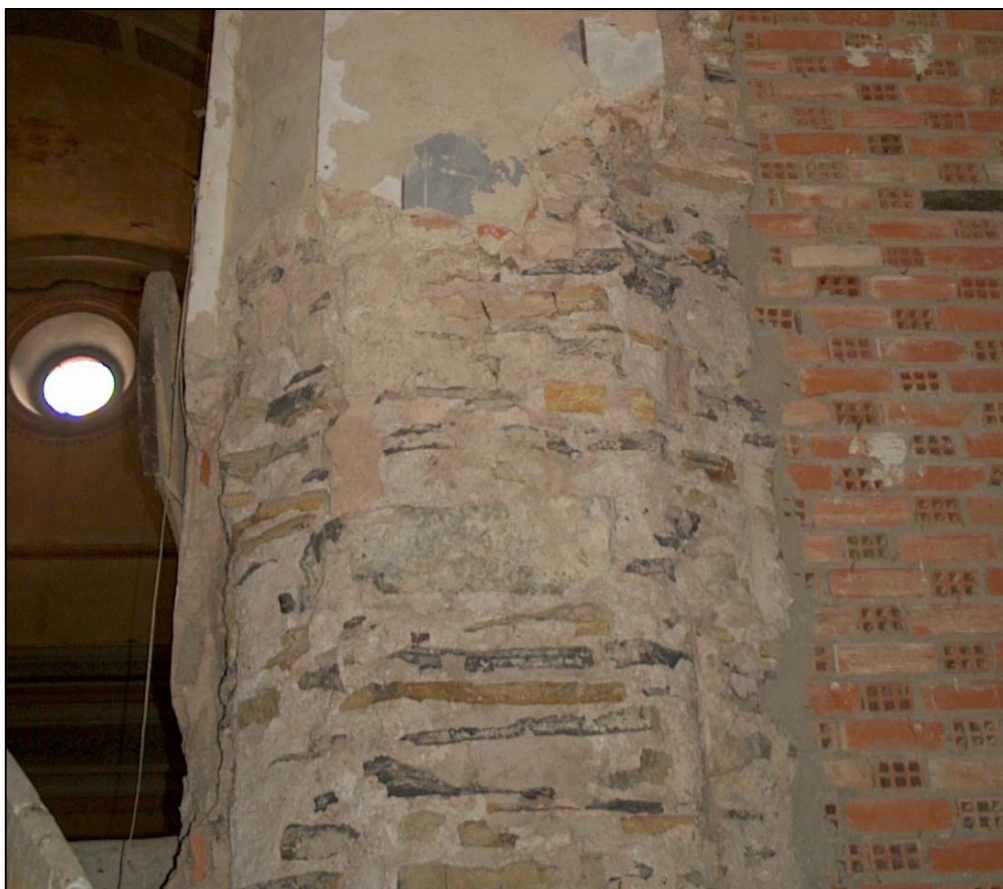
Figura 62: Soporte nº 3 izquierdo. Retirado el revestimiento. (José Torrent Martínez).
