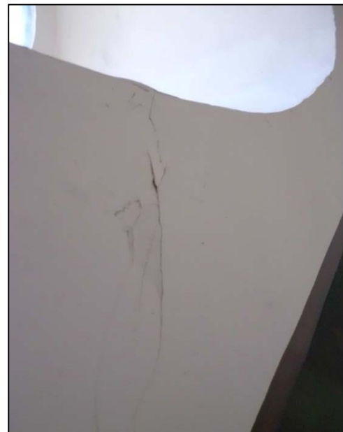
Figura 95: Grieta en el óculo izquierdo interior (25-04-2013)
