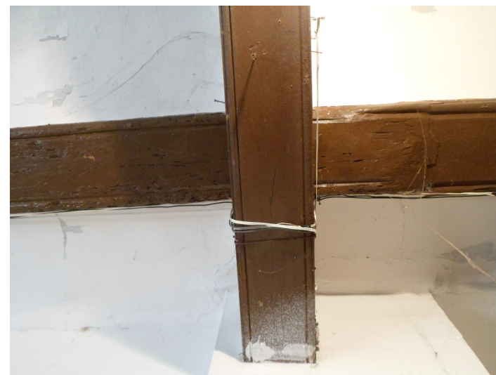
Deterioro vigueta de la estancia central 1
