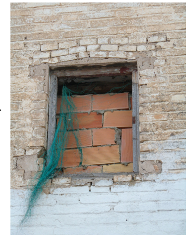
▶ Dintel realizado con ladrillo macizo de 24x12x4 cm realizando un arco de descarga.
