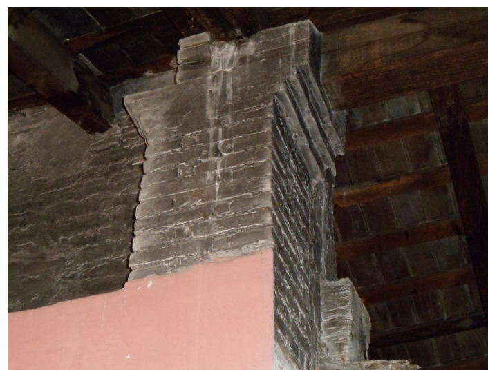
Filtraciones en zona central
