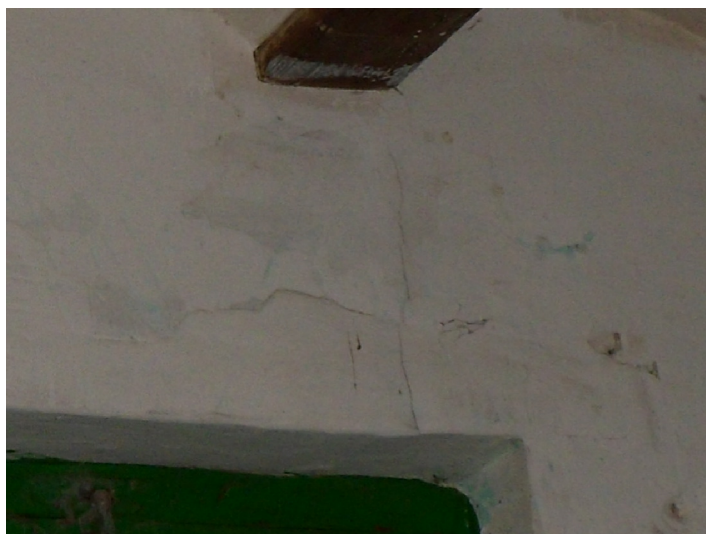
Grieta apoyo de viga
