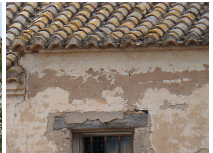
Grietas en fachada posterior
