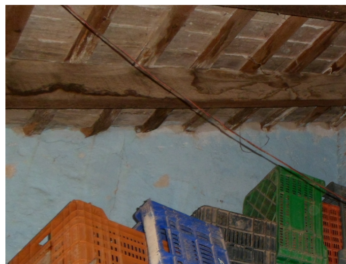
Filtraciones en el encuentro con el muro
