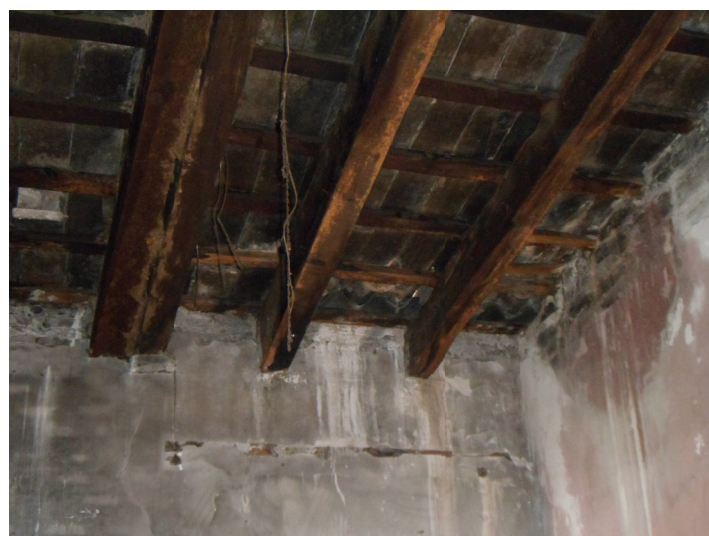
Filtraciones por muro de fachada
