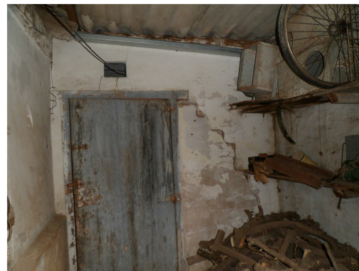
Grieta partición entre leñera y trastero
