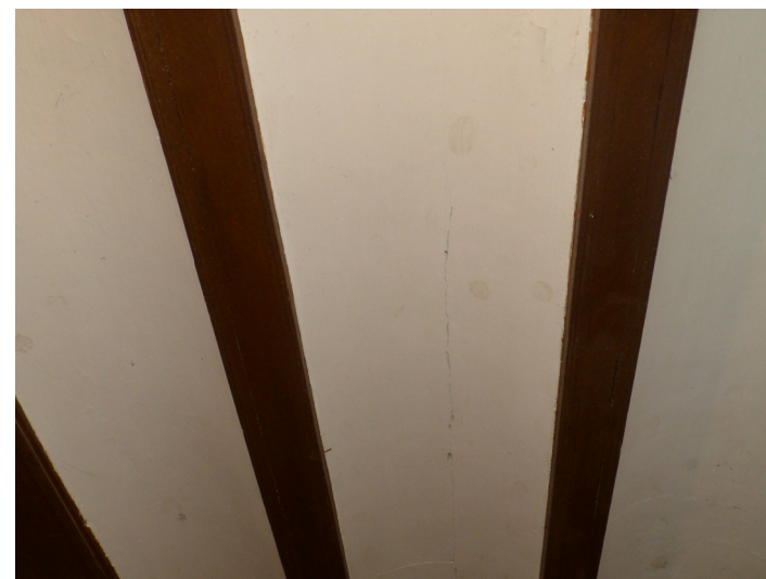
Grieta en revoltón estancia central
