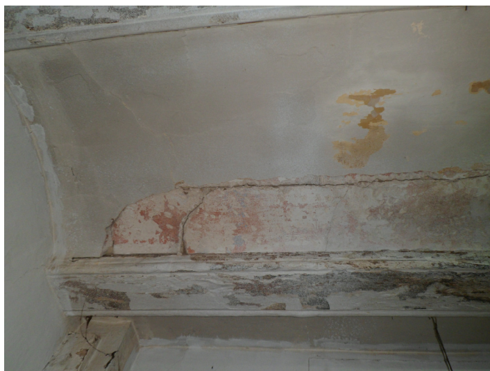
Deterioro de revoltón situado en la cocina
