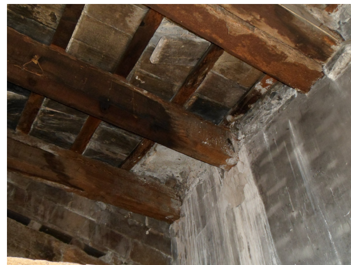
Filtraciones en el alero de la cubierta
