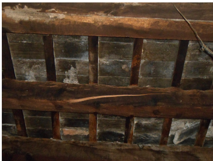
Rotura de par de la estructura portante de cubierta
