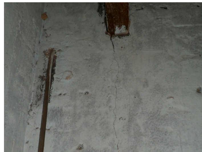
Grieta apoyo de par
