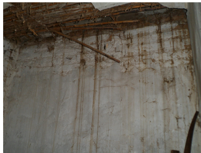
Filtraciones en el trastero
