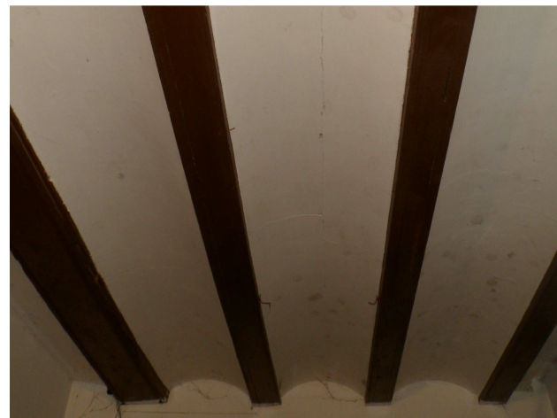
▲ Cara inferior del forjado de Planta Primera de la zona ZA.
