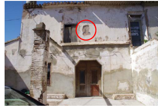
▲ Fachada correspondiente al número 28 de la alquería, en el círculo rojo se indica el sitio de donde arrancaron los azulejos. Abajo foto en la que se aprecia la forma de los azulejos.
