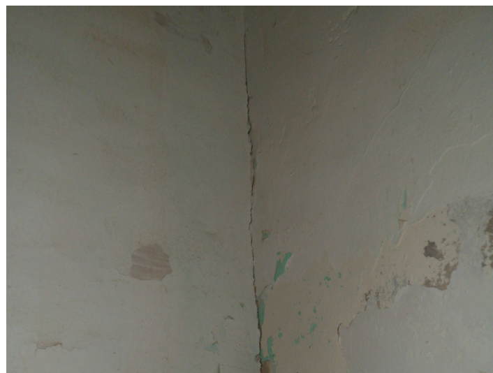
Grieta encuentro muro-tabique
