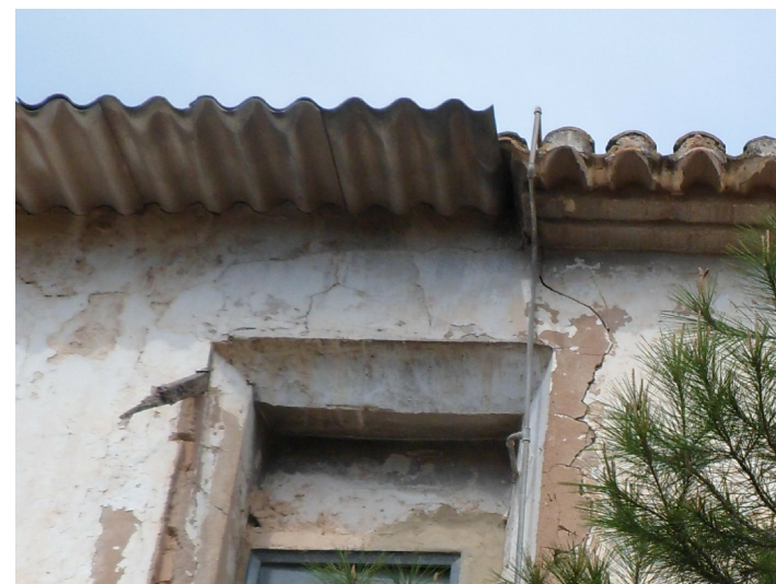
Grietas en fachada principal
