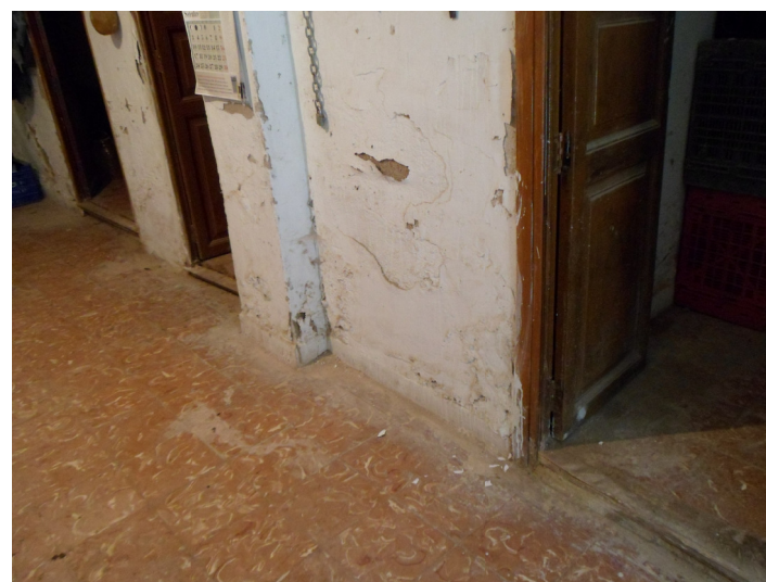
Deterioro en tabiquería interior
