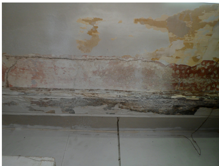
Deterioro vigueta de la cocina
