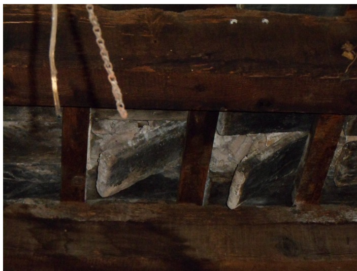
Caída de ladrillos del tablero de cubierta
