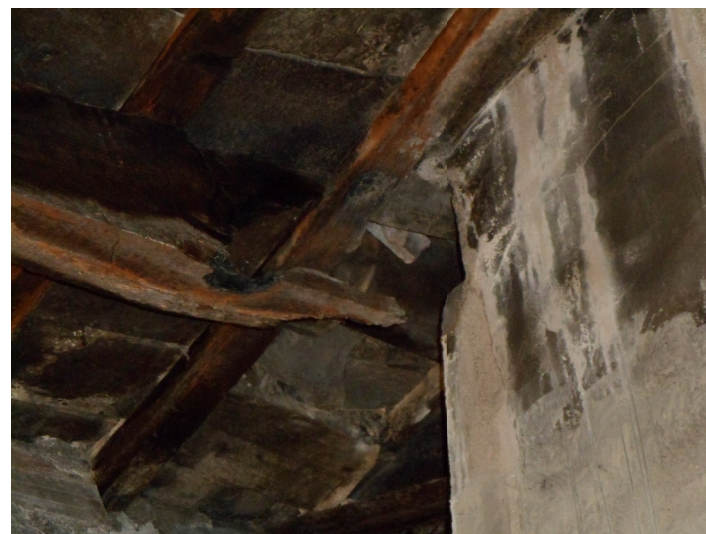
Falta sección del par
