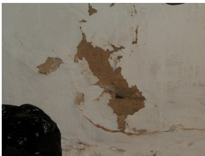
Deterioro en tabiquería interior
