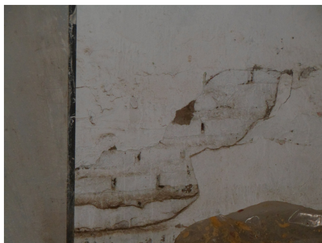
▲ Desconchado de mortero que permite ver el material con el que está realizado el muro
