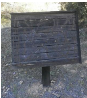
Figura 65. Base de un panel sin información. Fuente: Elaboración propia
