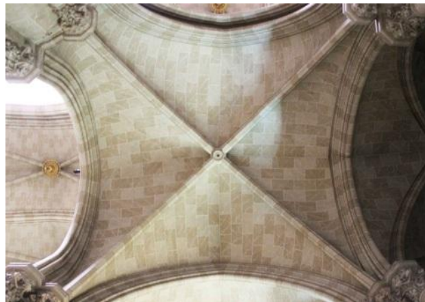
Bóveda de crucería de las naves laterales de la Basílica San Vicente Ferrer.
