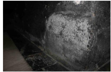
Eflorescencias en zócalos.
