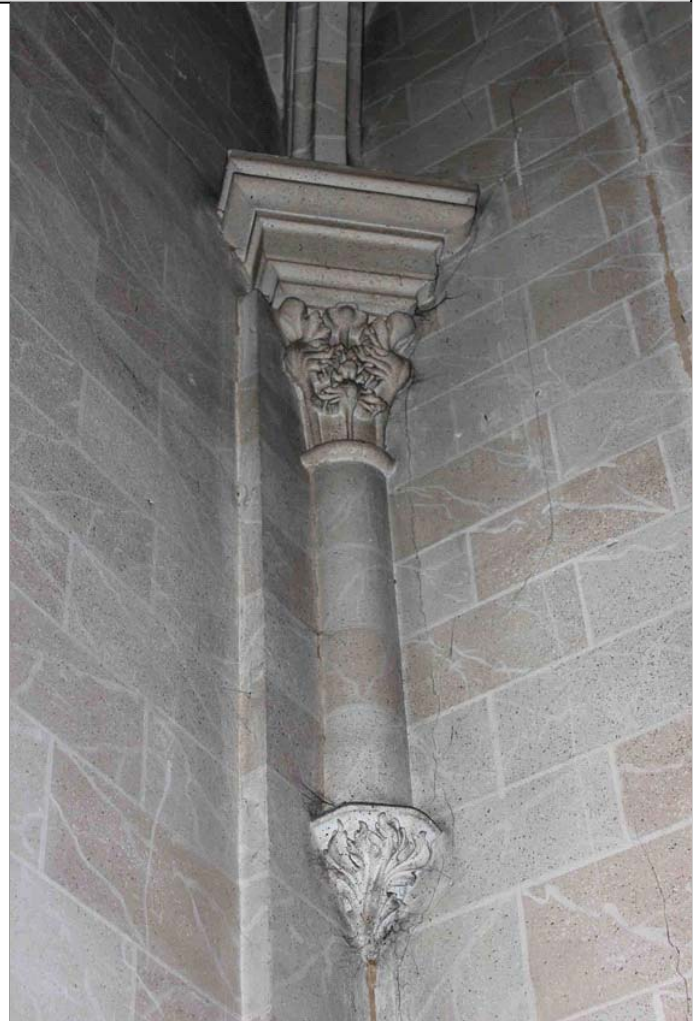
Imagen 1. Ornamentación de arranque de nervio diagonal de una de las bóvedas de las capillas. Por su geometría permite la acumulación de suciedad.
