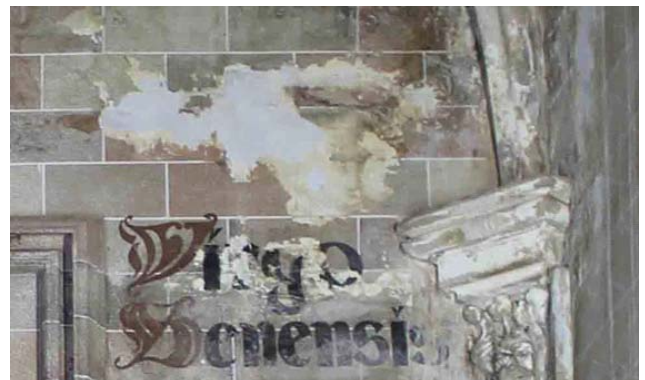
Imagen 2. Exfoliación de la pintura en el revestimiento interior de las capillas.
