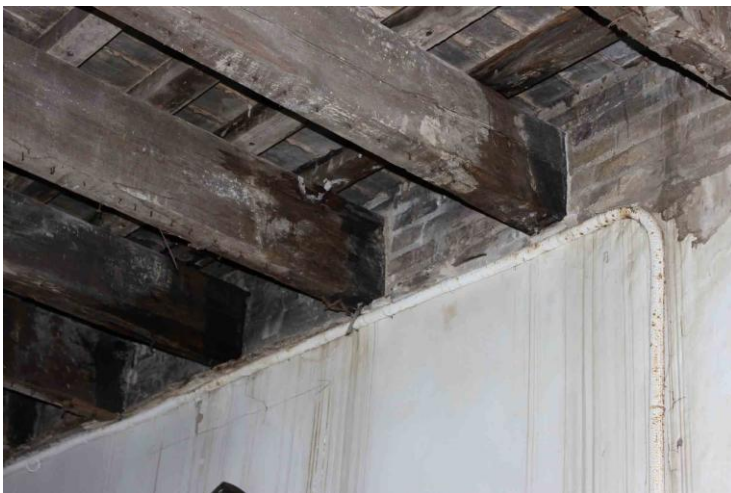
Hongos por pudrición en la cabeza de las vigas
