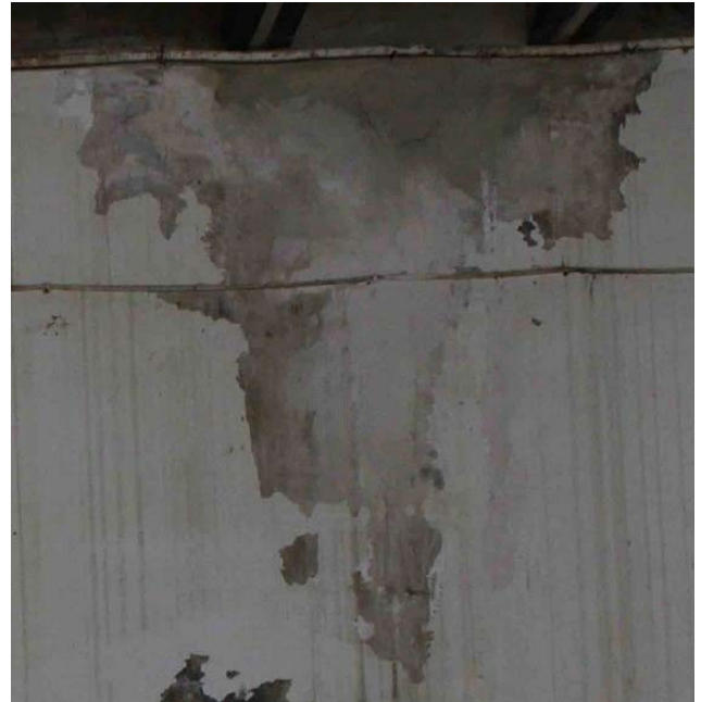
Imagen 1. Exfoliación de la pintura en el revestimiento interior de la tribuna.
