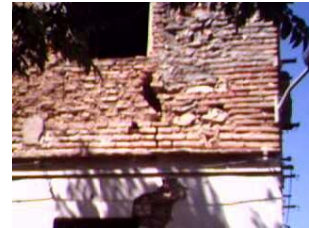
Grieta y desprendimiento de material en fachada Este. Fotografía cedida por el actual propietario.
