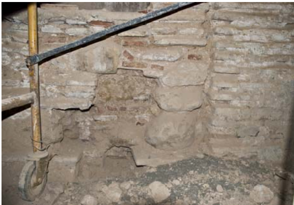
Fotografías del intradós del muro de fachada norte. (Fuente propia).
