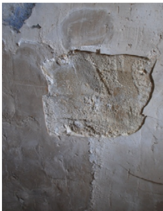
Eflorescencia paramento interior (Fuente propia)
