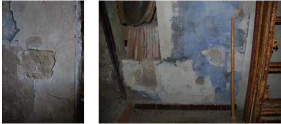
Eflorescencia y humedad por capilaridad
