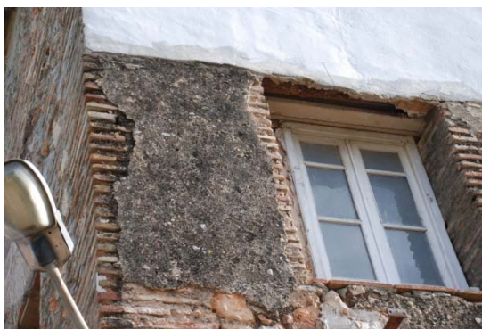
Detalle de lesión en enfoscado de fachada. (Fuente propia)
