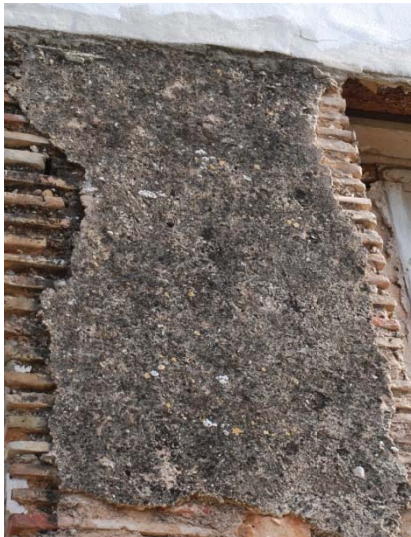
Líquenes fachada norte. (Fuente propia)
