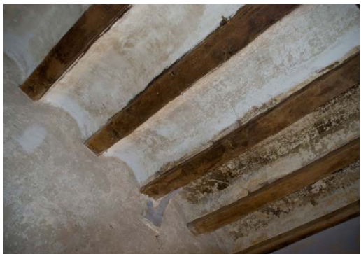
Bovedillas de ladrillo y capas de pintura. (Fuente propia)
