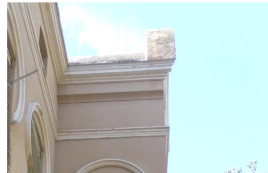
Cornisa de peso elevado
