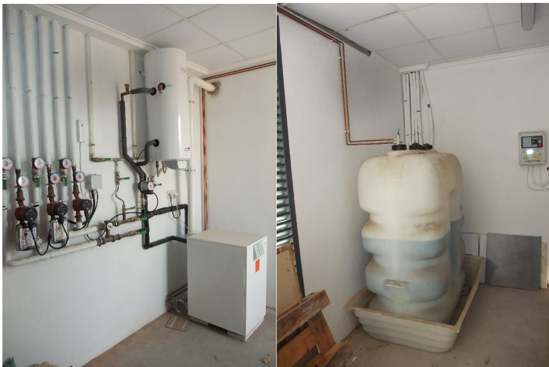
Figura IV.10: Cuarto de instalaciones
