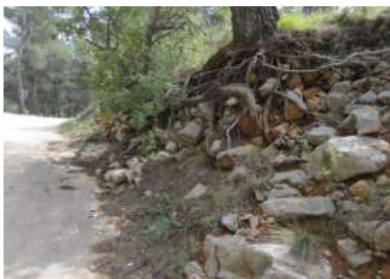
Figura 2.21: Ladera desmoronándose sobre el camino, dejando a un pino sin sujeción.
