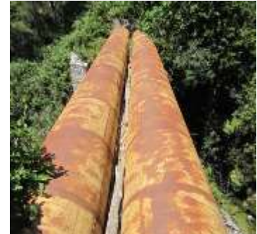
Figura 2.14: Vista superior de los tubos o canalizaciones de agua.
