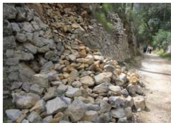
Figura 2.22: Muro de mampostería desmoronado en el Barranc de l'Infern.
