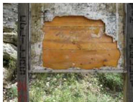
Figura 2.27: Panel interpretativo deteriorado en el Barranc de l’Infern
