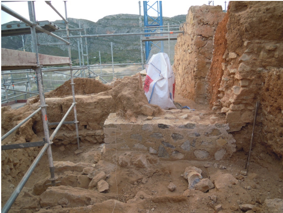
Imagen 3.43. Cimentación del muro de la torre original resuelta con muro de tapia de mampuestos con hormigón de cal.
