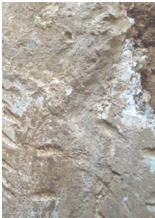
Imagen 3.76. Aspecto del enlucido donde se adivina un mortero añadido.
