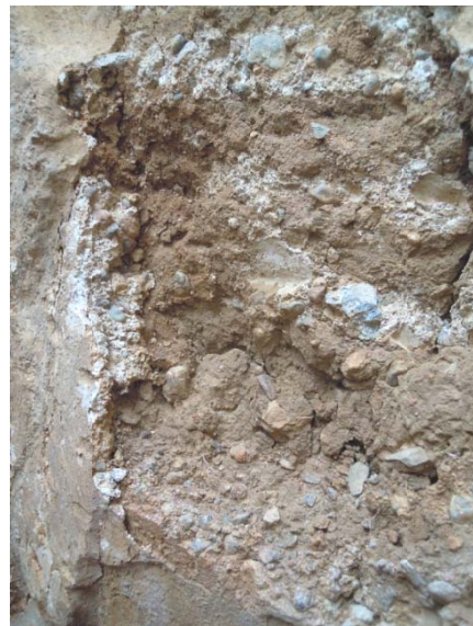
Imagen 3.64. Aspecto del borde de la rotura
