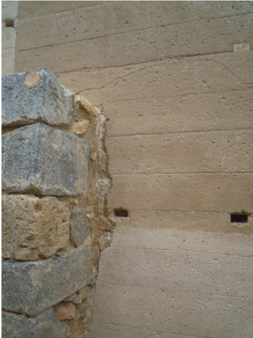
Imagen 3.16; Incisión en el paramento exterior marcando la existencia de media hoja interior de muro de tapia de tierra calicostrada
