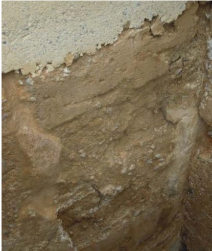
Imagen 3.61. Estado inicial. Faltantes en las diversas capas de la fábrica
