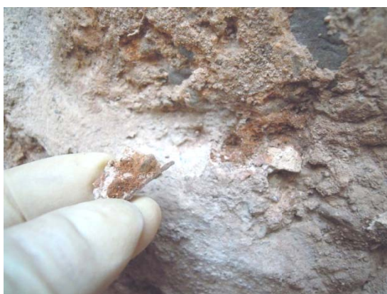
Imagen 3.82. Trozo de mortero adherido a la tierra de tapial.
