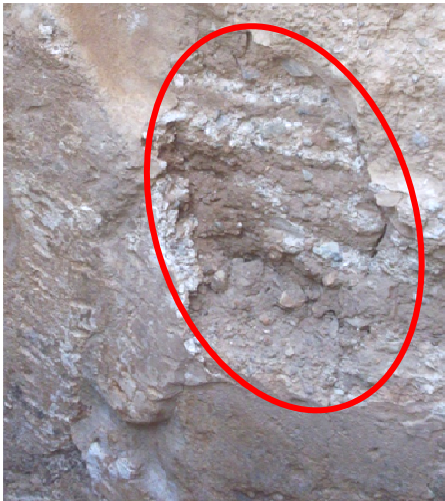
Imagen 3.63. Apecto inicial del paramento faltante central.
