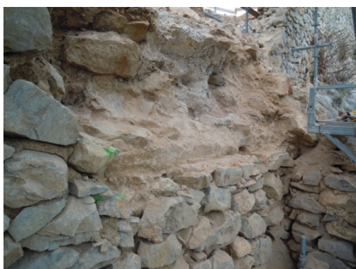
Imagen 3.25; Agujas encontradas en restos de muro de tapia de tierra calicostrada
