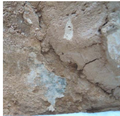
Imagen 3.72. Detalle resina y grietas
