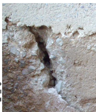
Imagen 3.89. Tramaño de la grieta bajo el mortero, profundidad importante
