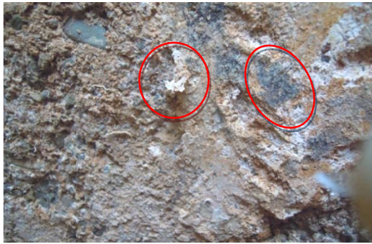
Imagen 3.69. Láminas de resina semiadheridas; zonas ennegrecidas
