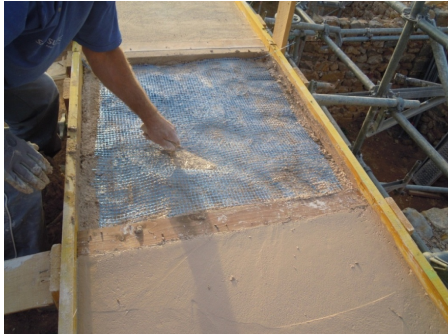
Imagen 3.11: Momento de la creación de la coronación de la tapia con hormigón de cal y colocando la malla de fibra de vidrio y los bastones
