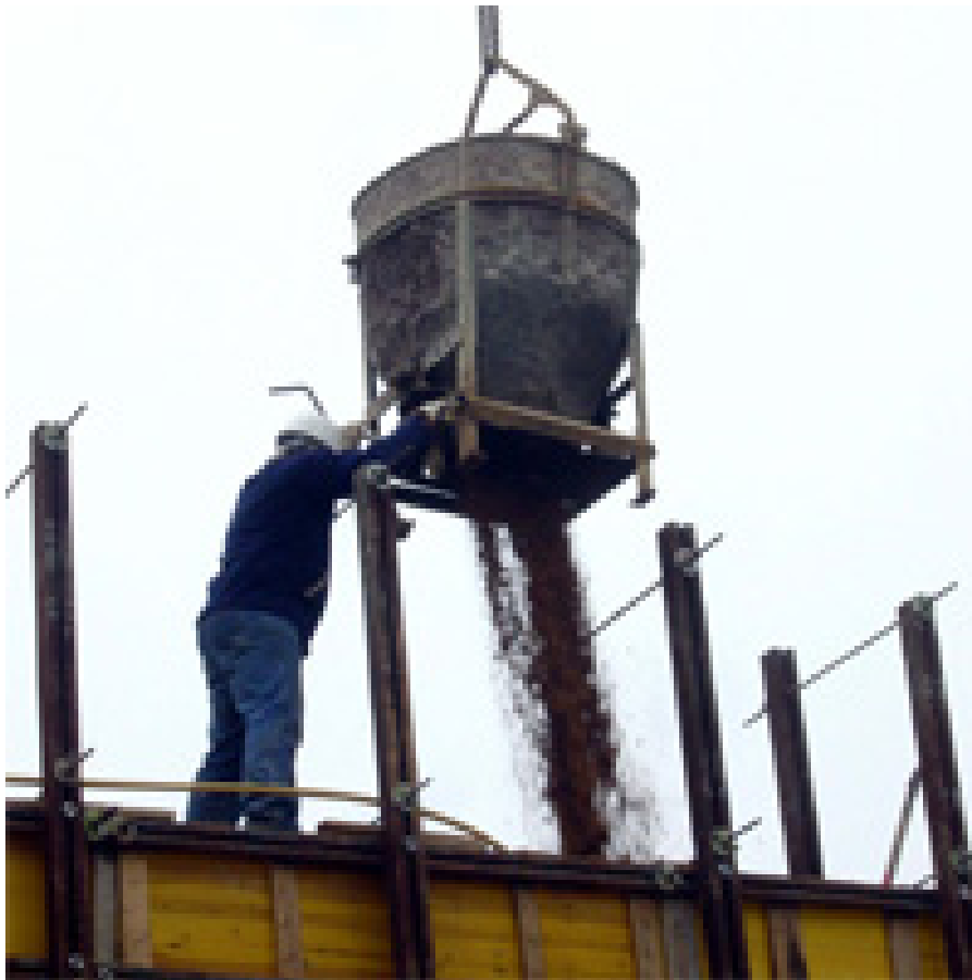
Imagen 2.4. Elevación y vertido de la tierra mediante balde de hormigón y grúa torre.
