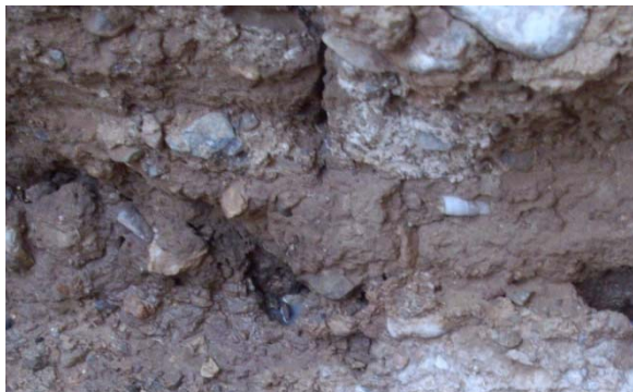
Imagen 3.112: Aspecto del tapial disgregado y con múltiples entradas de agua.
