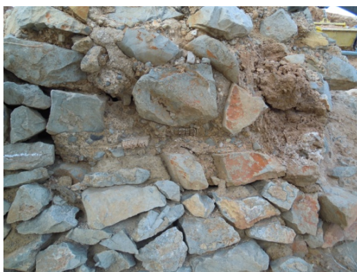
Imagen 1.22: Hallazgo de de Muro Tapia de Piedra con Hormigón de Cal en el Castillo de Oropesa
