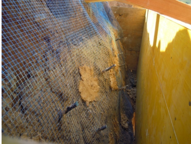
Imagen 3.13: Colocación de Malla de fibra de vidrio y de varillas de fibra de carbono
