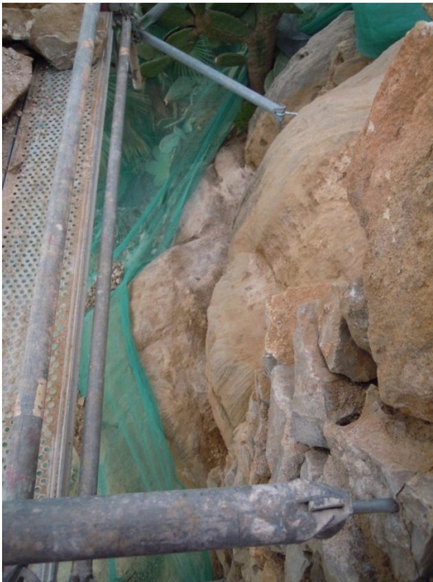
Imagen 3.24; Faltante de muro de mampostería exterior
