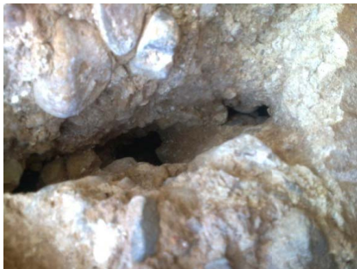
Imagen 3.86. Detalle del hueco posterior, que se extiende hacia abajo
