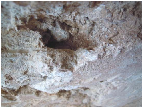
Imagen 3.84. Trasera del enlucido hueca y sin relleno.
