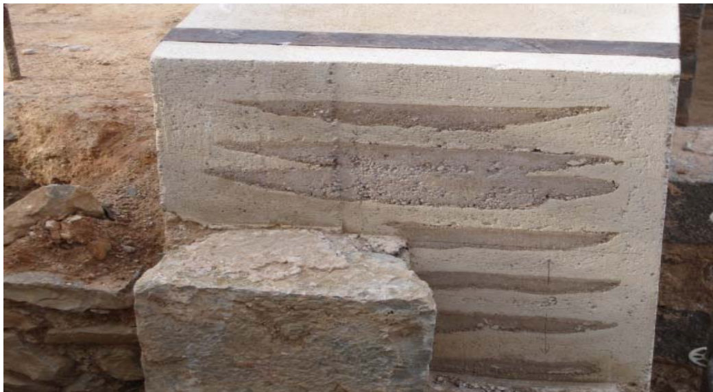
Imagen 1.6: Tapia Calicostrada ejecutada en La Consolidación de murallas del Castillo de Oropesa
