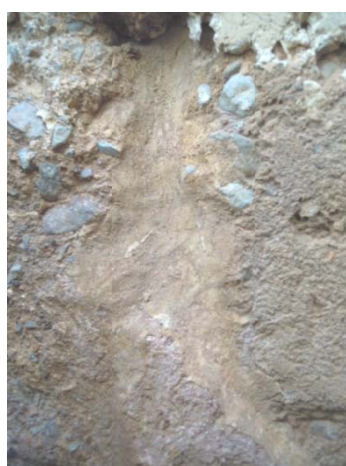
Imagen 3.88. Grieta superior tapada con mortero . (Y mimetizada)
