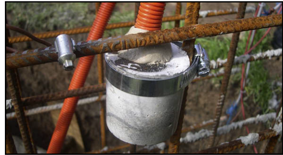
Figura 1.3. Multisensor embebido en muro de contenedor de residuos radioactivos.
