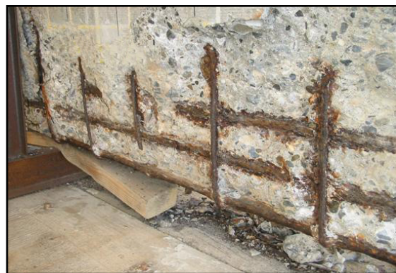
Figura 2.106. Desprendimiento del recubrimiento del armado de una viga de un puente.
