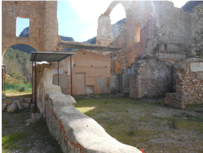
Reconstrucción y consolidación del muro de la iglesia que fue intervenido en las obras anteriormente citadas.
