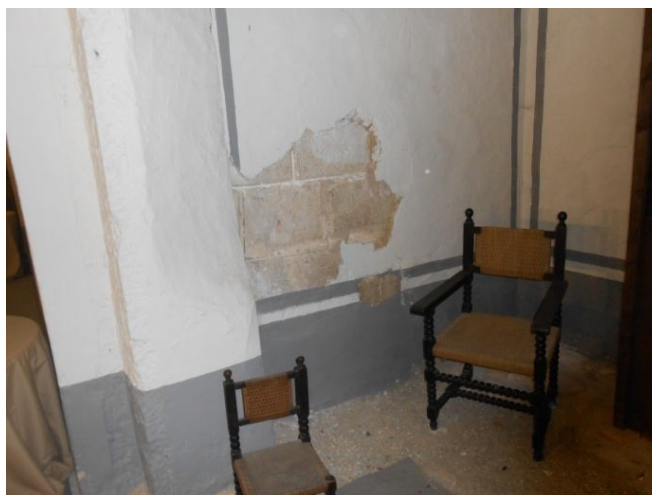
Imagen que muestra que para la conservación y rehabilitación de la nave de la iglesia se ha escogido cubrir las piedras de sillería que forman los muros de la misma.
