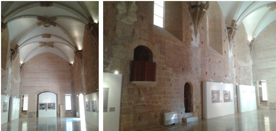
El trabajo de restauración que se ha llevado a cabo en el Refectorio se aprecia de una mejor forma desde su interior, pudiendo contemplar la bóveda totalmente reconstruida. Reposición de los nervios y colocación de claves recuperadas.
