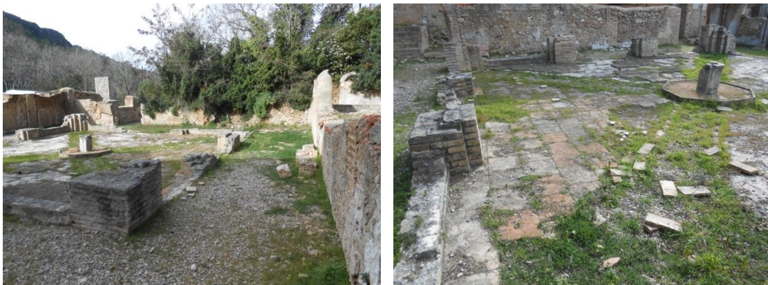
La imagen de la izquierda se corresponde con lo que debería ser los pasillos del claustro, hoy en día casi desaparecidos en su totalidad, así como el pavimento existente en el patio del mismo (imagen de la izquierda).
