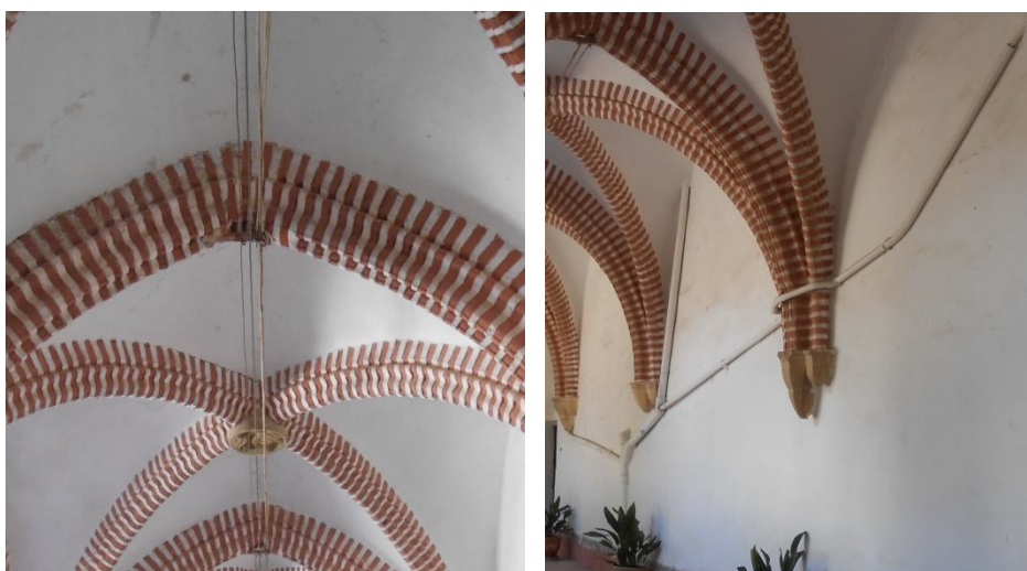
Presencia de elementos impropios que perjudican la contemplación del conjunto del claustro, tales como piezas clave, nervios de la bóveda o ménsulas.
