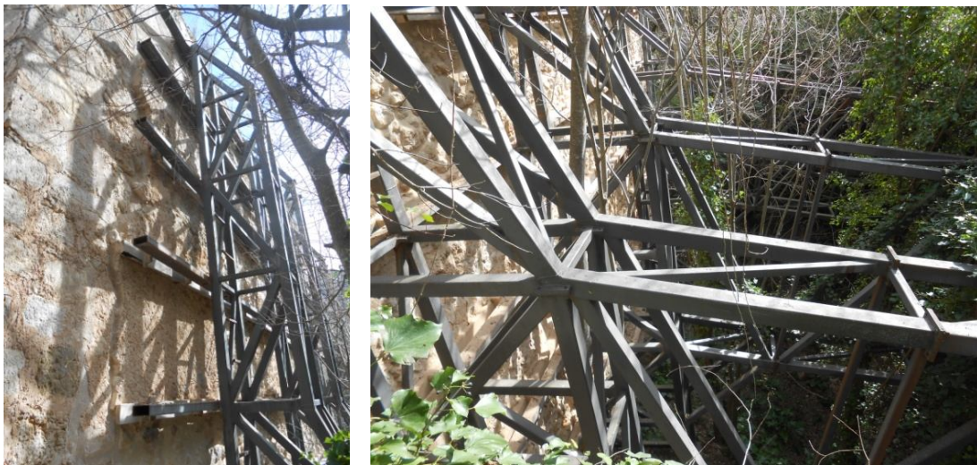
Estructura metálica de consolidación erigida en el barranco y con la finalidad de soportar y mantener el muro Sur de la iglesia.
