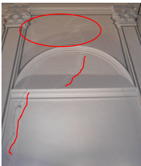
Pequeñas grietas y desconchamientos como consecuencia de la humedad en el interior de la iglesia.
