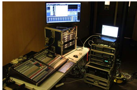
Figura 23. Instalación de control de sonido II.
