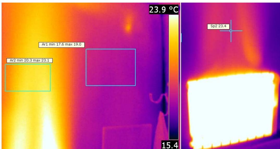
Imagen IR 4.13. Interior Dormitorio principal. Efecto chimenea del radiador.
