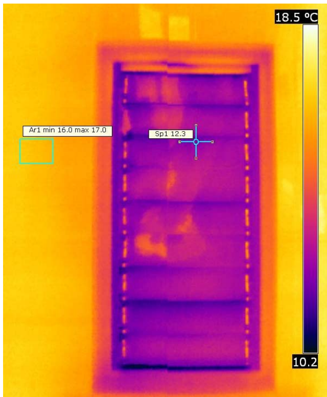
Imagen IR 4.14. Ventana de baño. Fachada Oeste.
