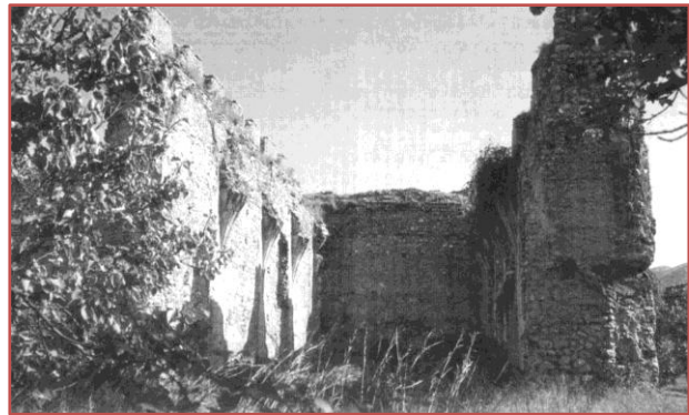
Fotografía 44 - Refectorio, sin cubierta y en su peor estado.
