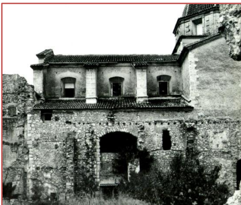
Fotografía 40 - Paso impropio en la 5ª capilla.
