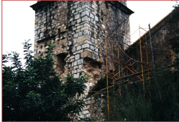
Fig. 68 - Vista del boquete en la esquina del campanario.
