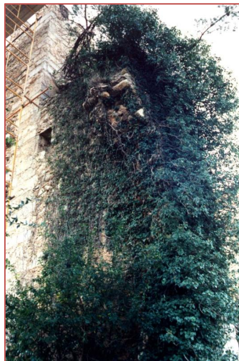
Fig.55 Muro norte afectado por la vegetación.
