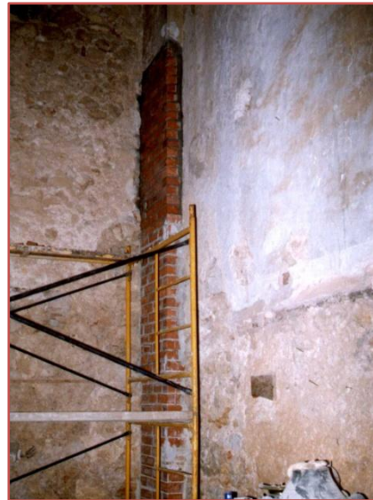
Fig.45 - Refuerzo de esquina
