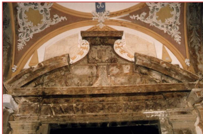
Fig.48 Puerta de acceso a la Iglesia vista desde el atrio, el dintel de madera presenta una clara curvatura debida al peso.
