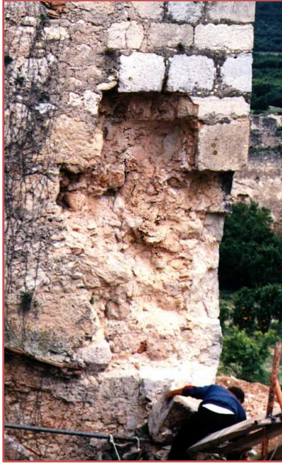
Fig. 69 - El boquete antes de la reparación.
