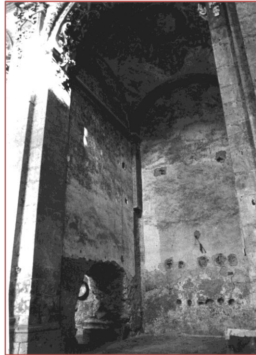
Fig.43 - Estado ruinoso de una delas capillas.
