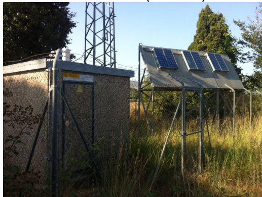
Figura 5. Estación de aforo del río Vernisa
